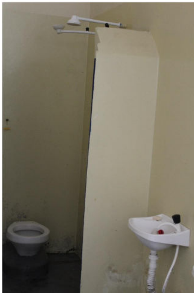
Foto do local evidentemente inadequado em que os chuveiros com água quente foram instalados na unidade
