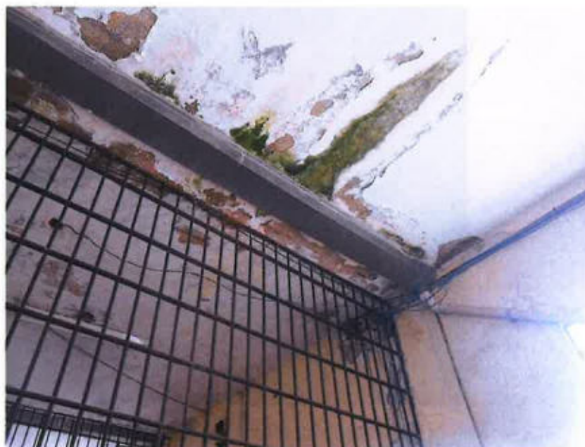
(Infiltração e rachaduras nas galerias)
