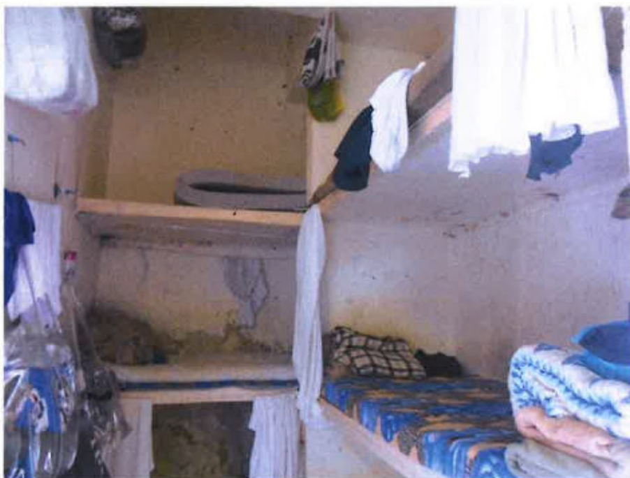
(Condições da cela com paredes descascando)
