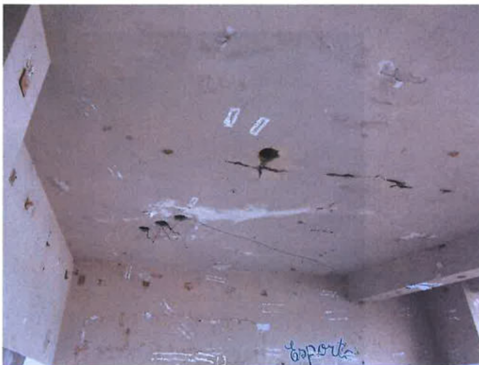
(Rachaduras no teto do pavilhão I)
