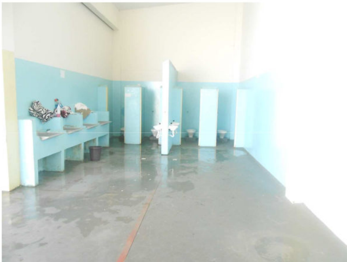
(Foto demonstrando a ausência de portas nos banheiros que dão para o pátio)
