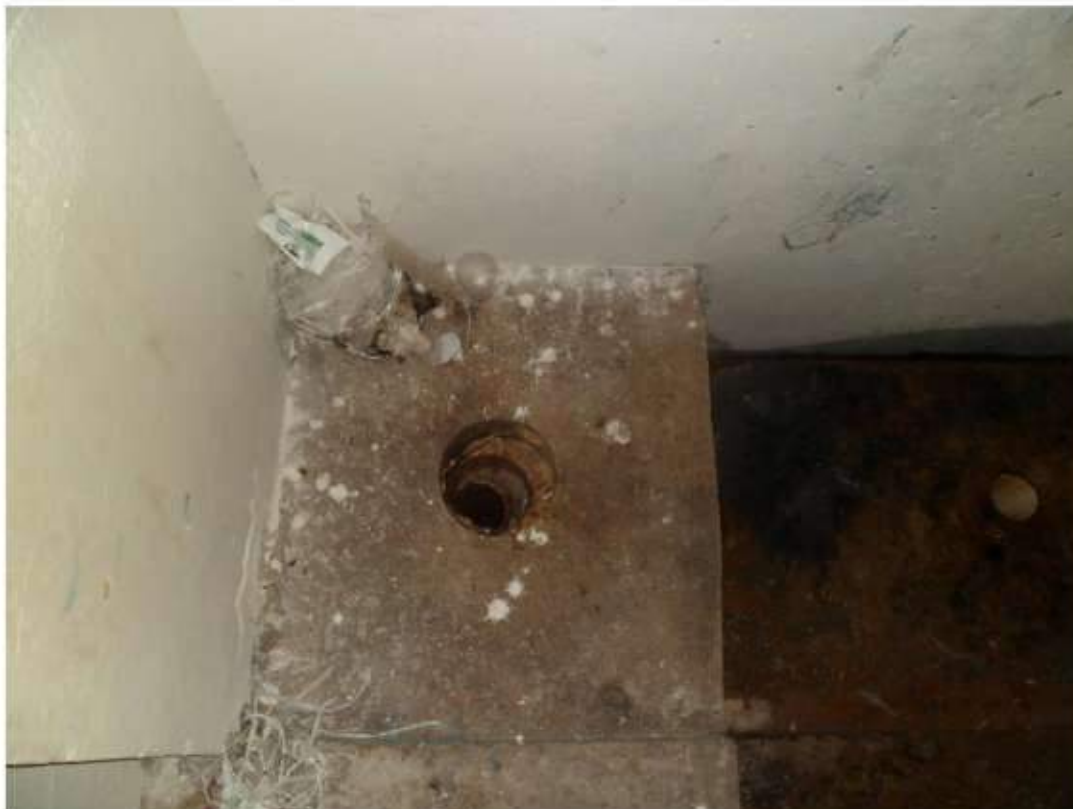
Precariedade das instalações da unidade
