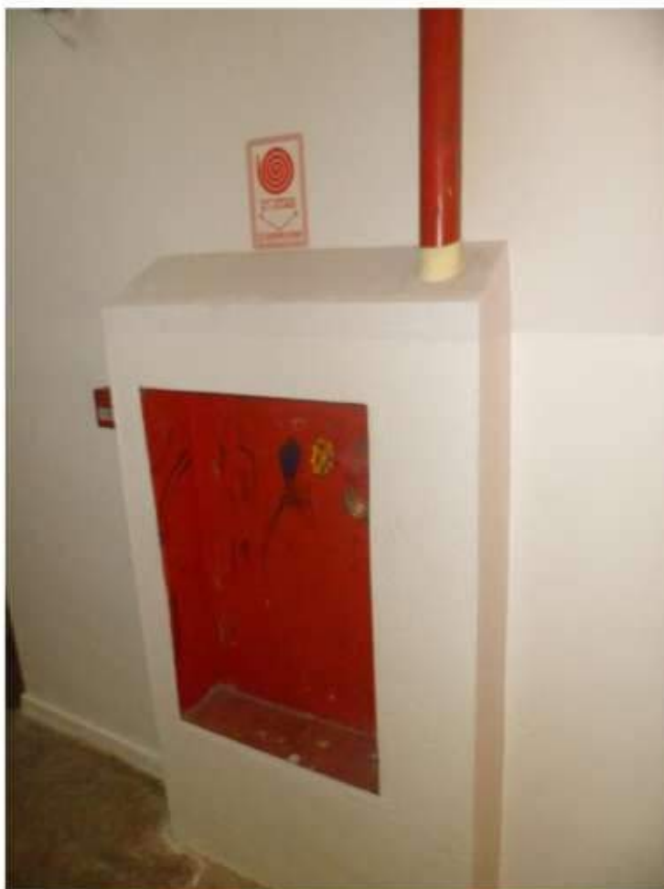
Irregularidade do sistema anti-incêndio
