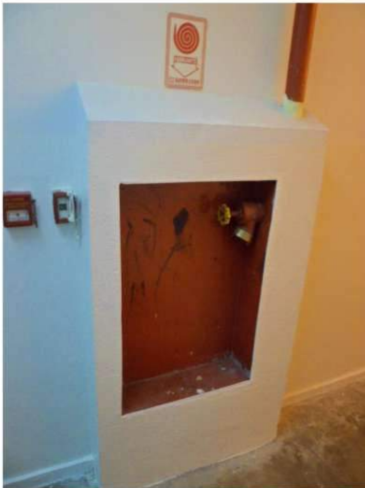
Irregularidade do sistema anti-incêndio
