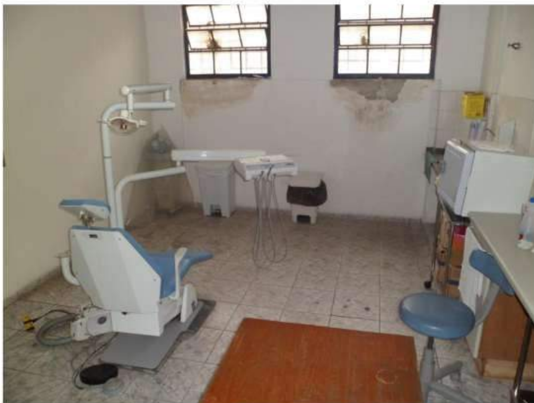
Sala de dentista em estado ruim
