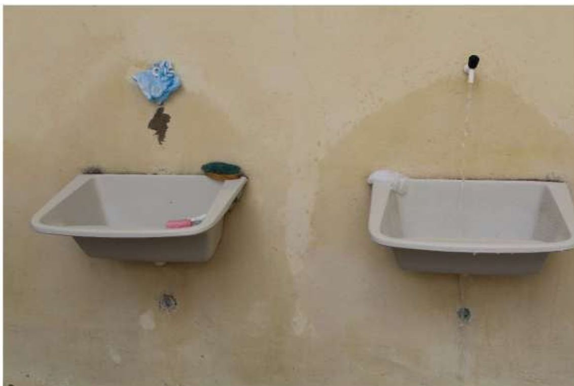
(Tanques sem sifão instalado no pátio do pavilhão)
