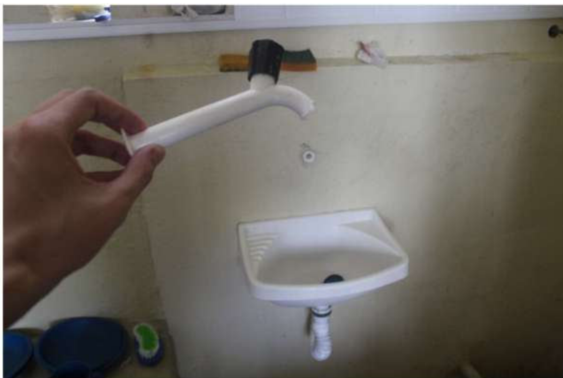
(Torneira desinstalada no interior da cela)
