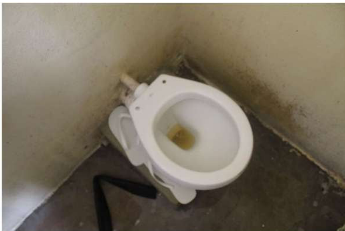
(Vaso sanitário sem instalações adequadas para descarga)
