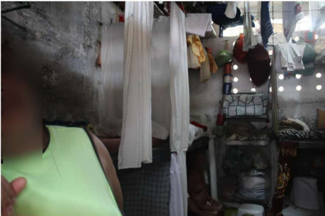
(Infiltração – celas deterioradas)
