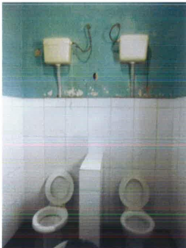
(Vasos sanitários no banheiro dos alojamentos)
