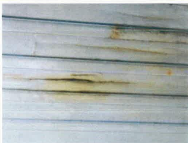
(Danos no teto da unidade)
