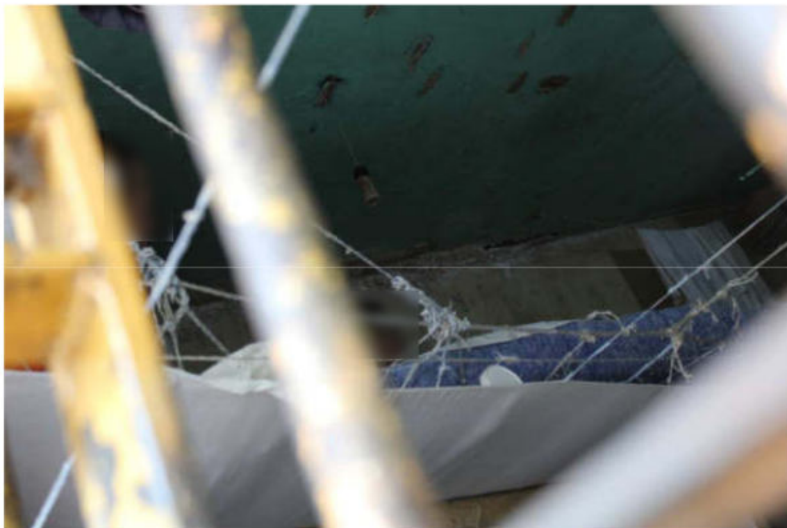
(Rachaduras nas paredes e tetos das celas)
