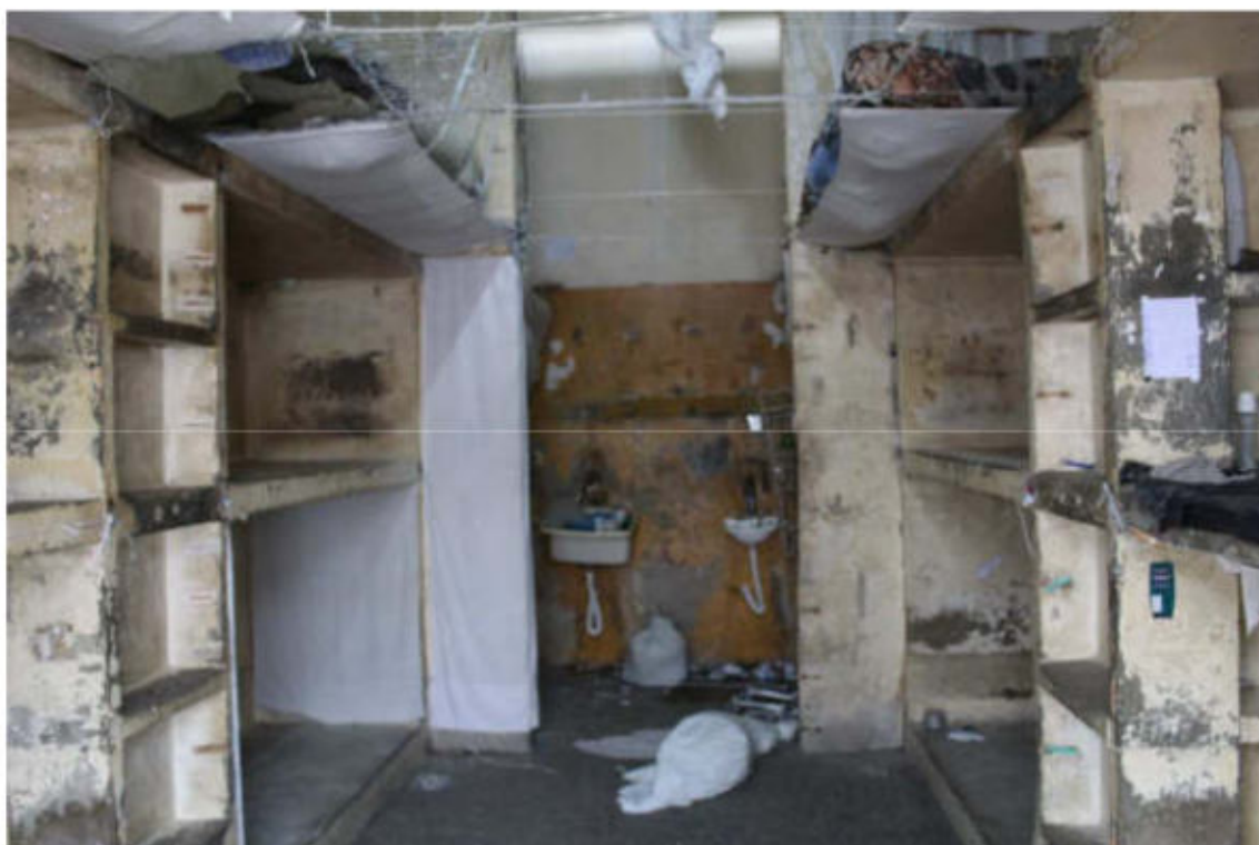
(Cela vazia no raio 08, na qual é possível perceber o estado de deterioração)
