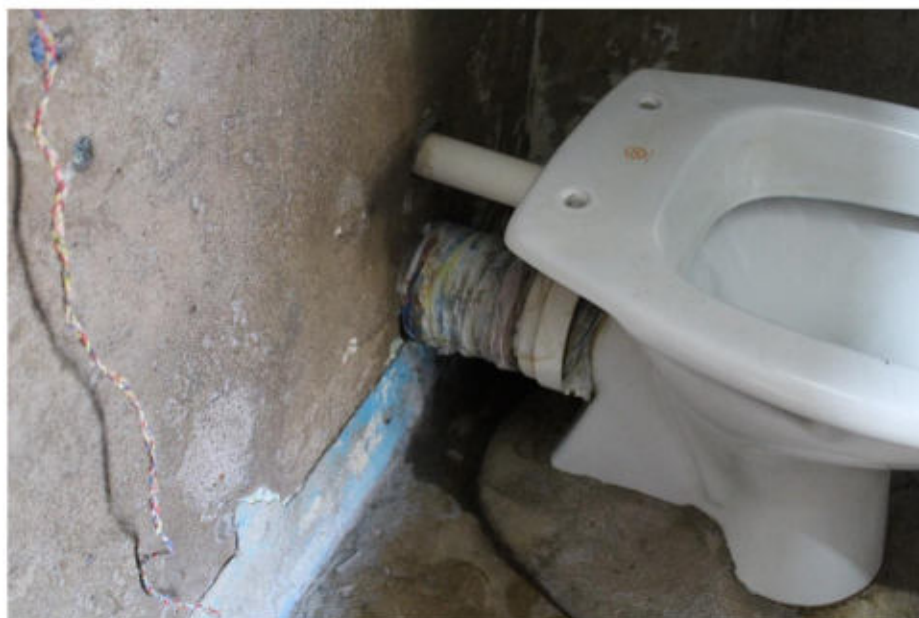
Vaso sanitário com encanamento improvisado para evitar vazamentos
