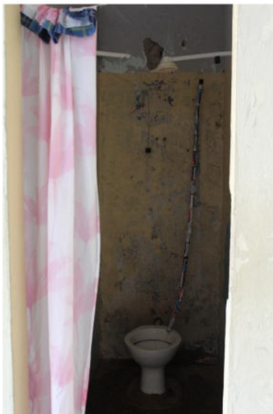
Dois chuveiros instalados sobre um vaso sanitário
