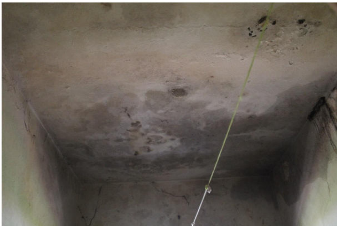
Teto de uma das celas do setor disciplinar. Detalhe para a ausência de iluminação artificial.
