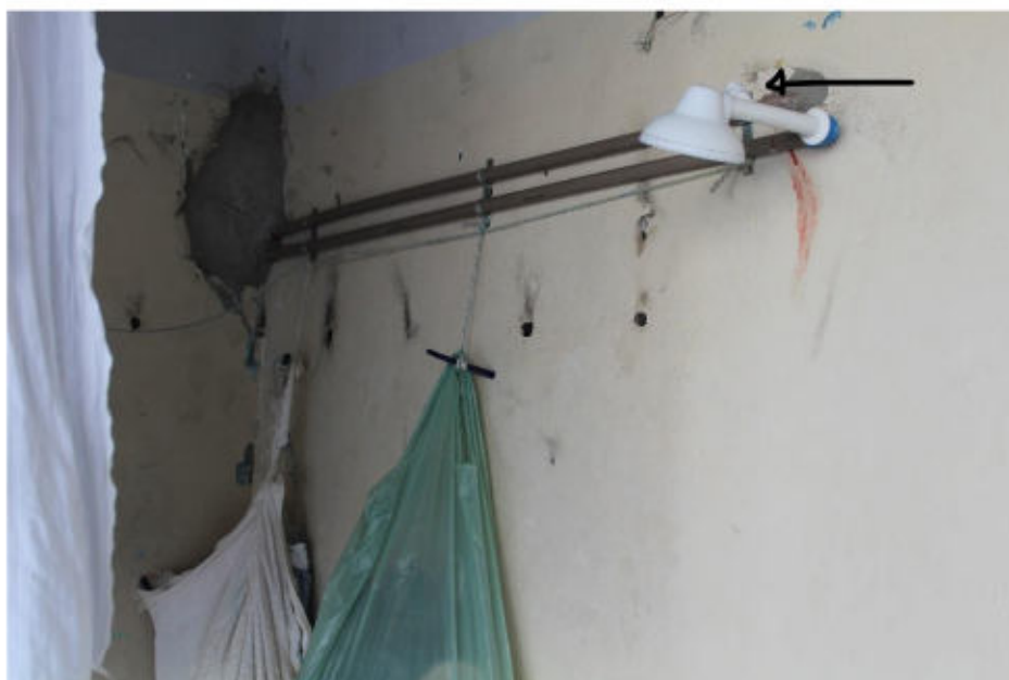
Detalhe para a ausência de registro
