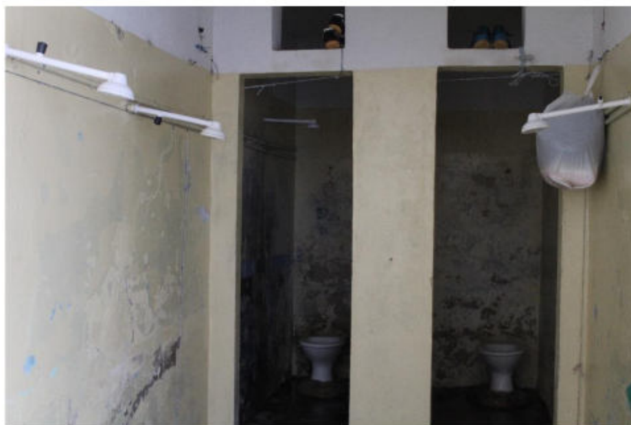
Chuveiros recém-instalados em locais completamente inadequados e que não funcionam
