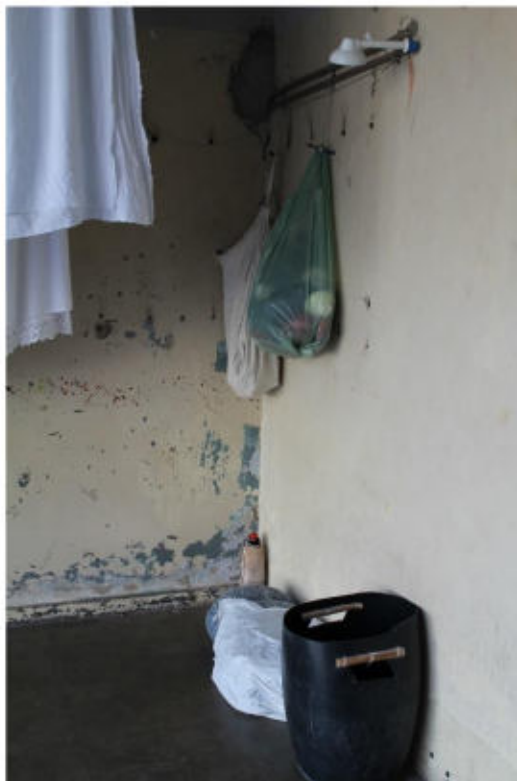
Chuveiro recém-instalado sem funcionamento com objetos embaixo
