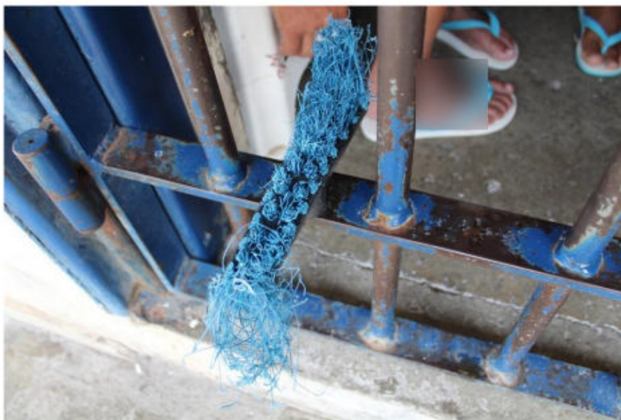
Pedaço de vassoura em péssimo estado de conservação
