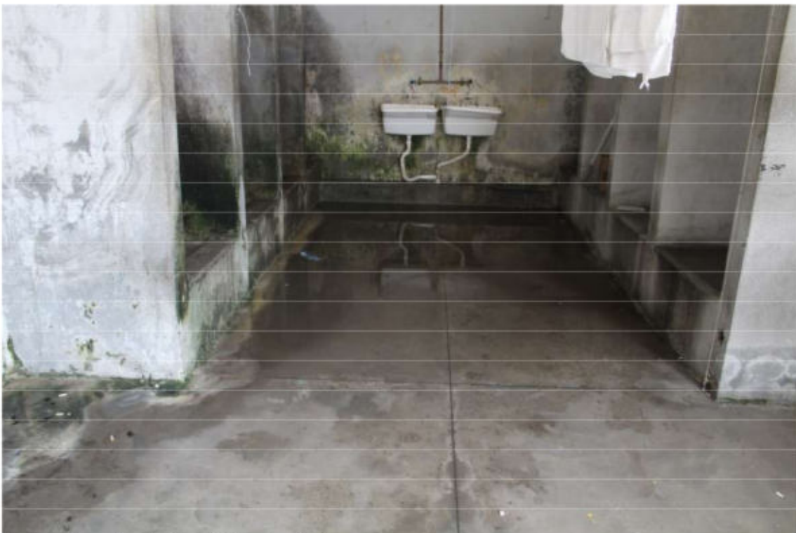
Vazamento no banheiro coletivo do raio 6.
