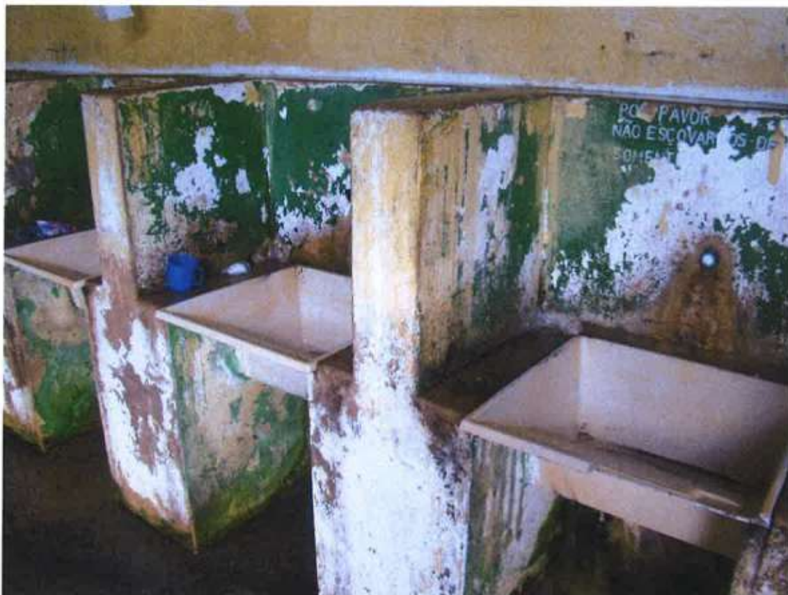
Péssimo estado de conservação dos tanques do raio 8
