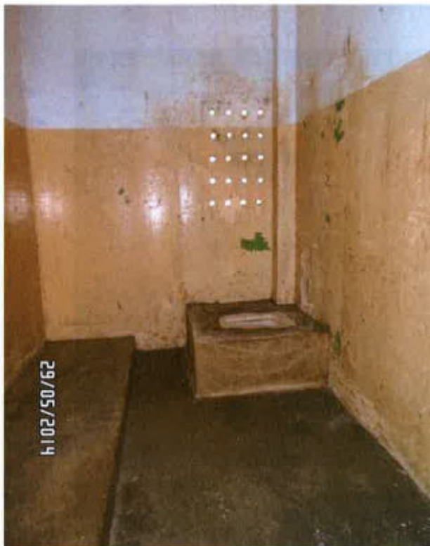
Interior de outra cela do castigo, onde é possível verificar a péssima estrutura de passagem de luz e ventilação, consistente em pequenos furos na parede.
