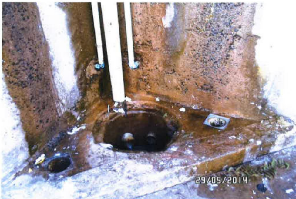
Outra imagem do vazamento, possivelmente na rede de esgoto.
