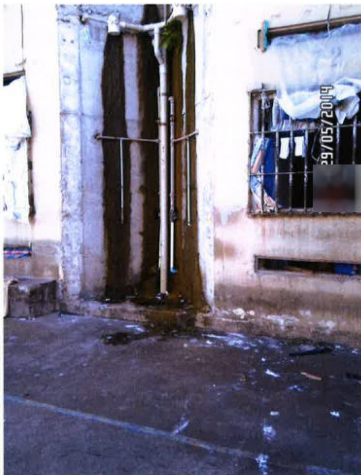
Vazamento na área externa à das celas, no interior do raio.
