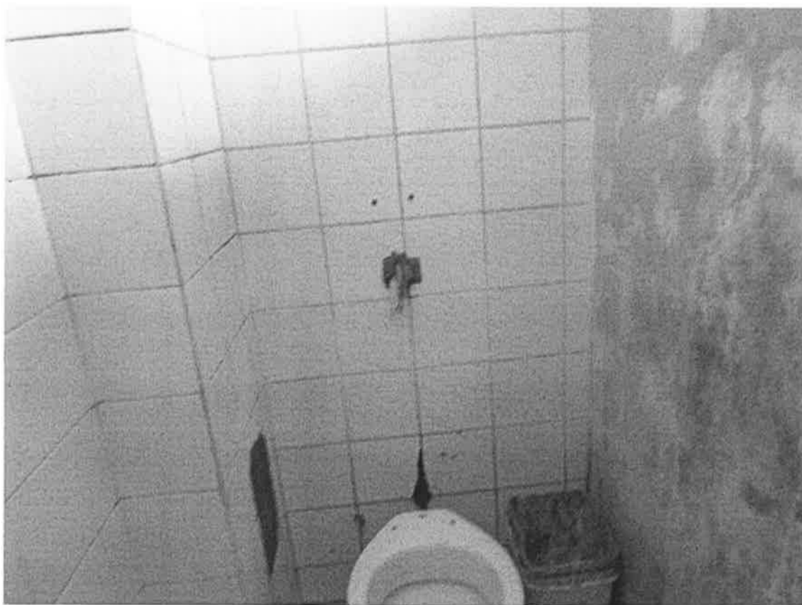
Figura 24 privadas sem tampa e sem dispositivo de descarga
