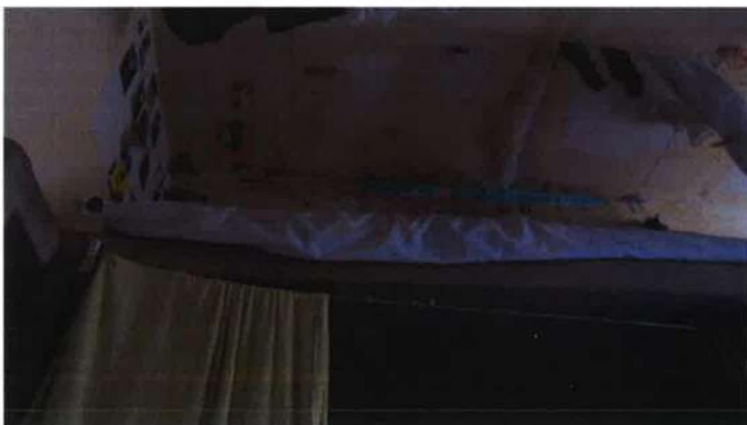
Figura 39 Exemplo de infiltração – cela do convívio
