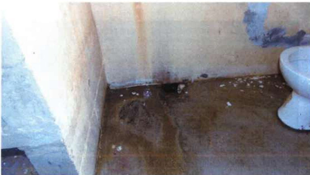
Figura 6 Vazamento – Cela RDO
