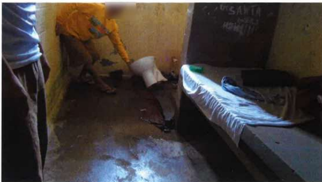
Figura 5 Cela do RDO com vazamento e vaso sanitário quebrado
