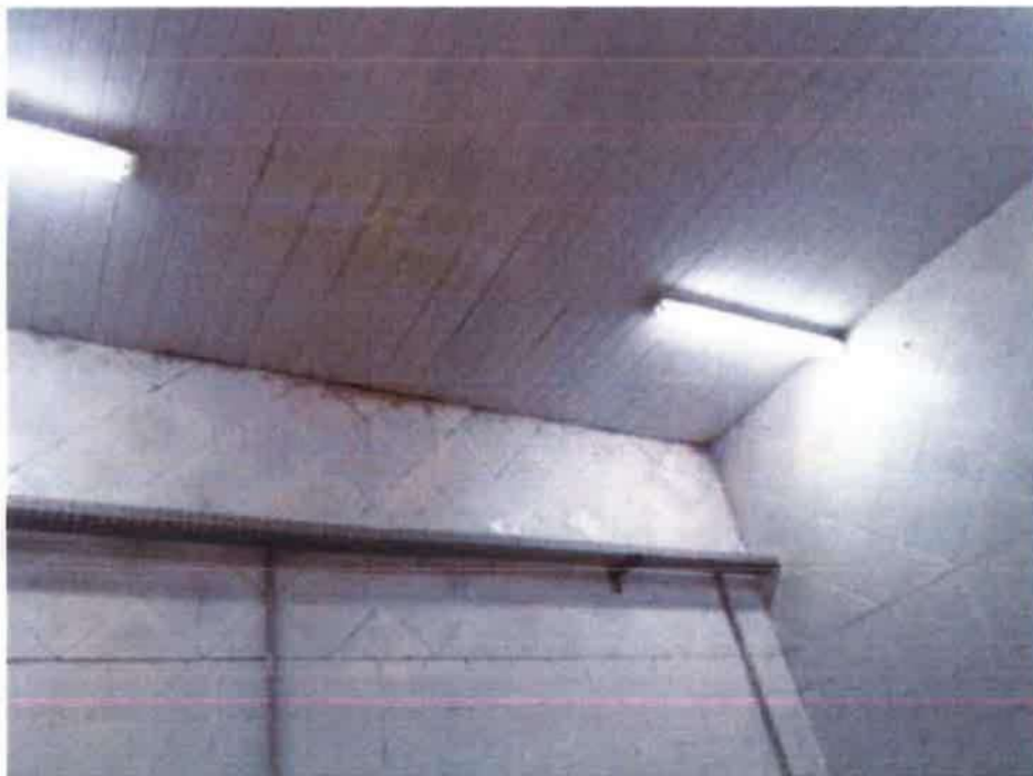
Sujeira e mofo no teto da cozinha
