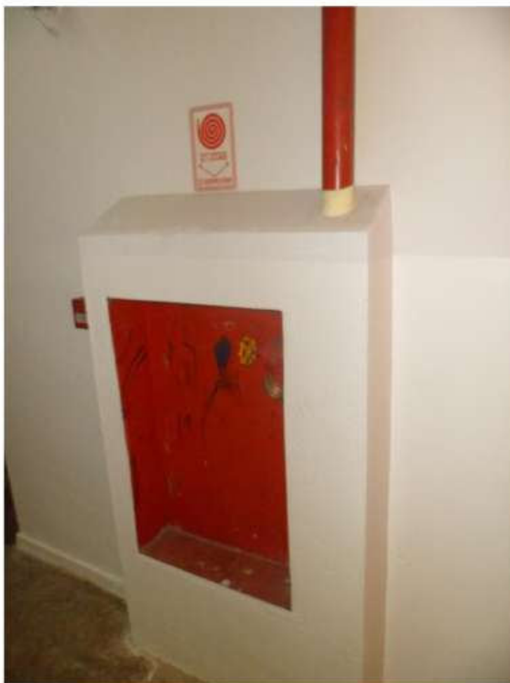
Irregularidade do sistema anti-incêndio
