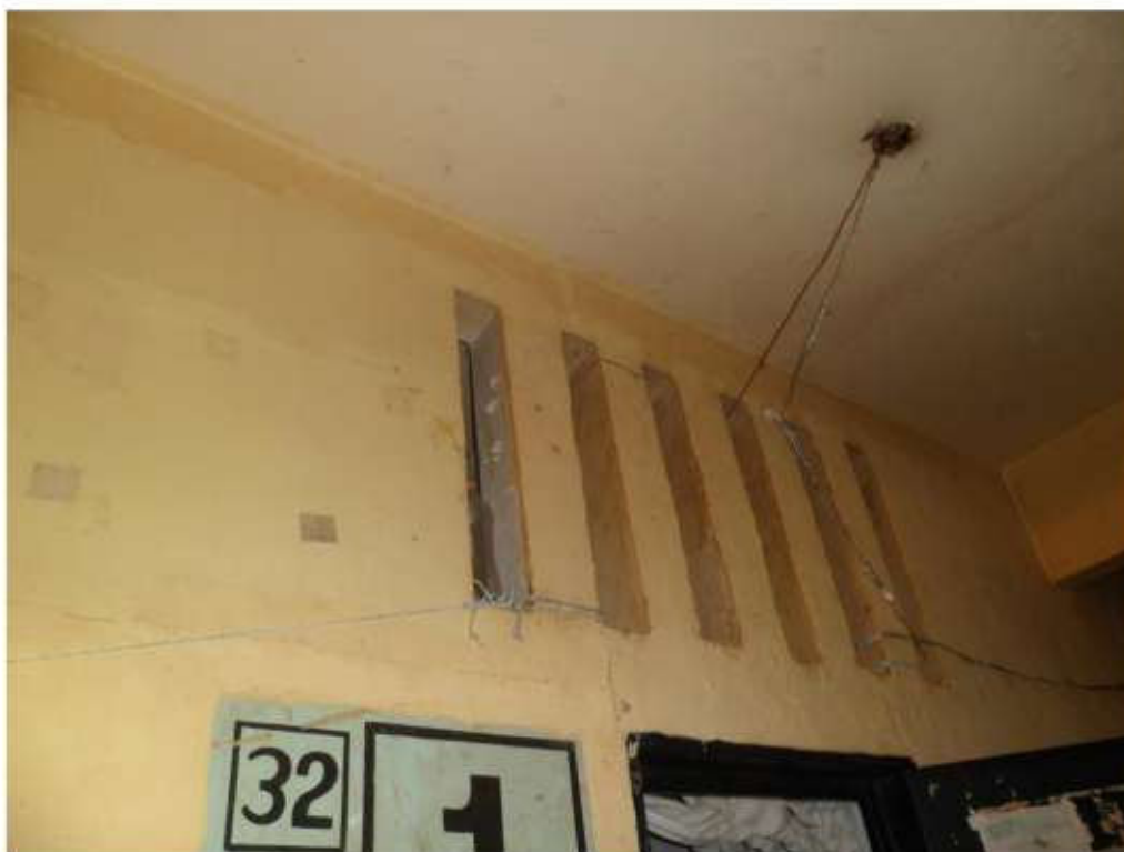
Falta de lâmpadas em todos os locais de habitação de presos
