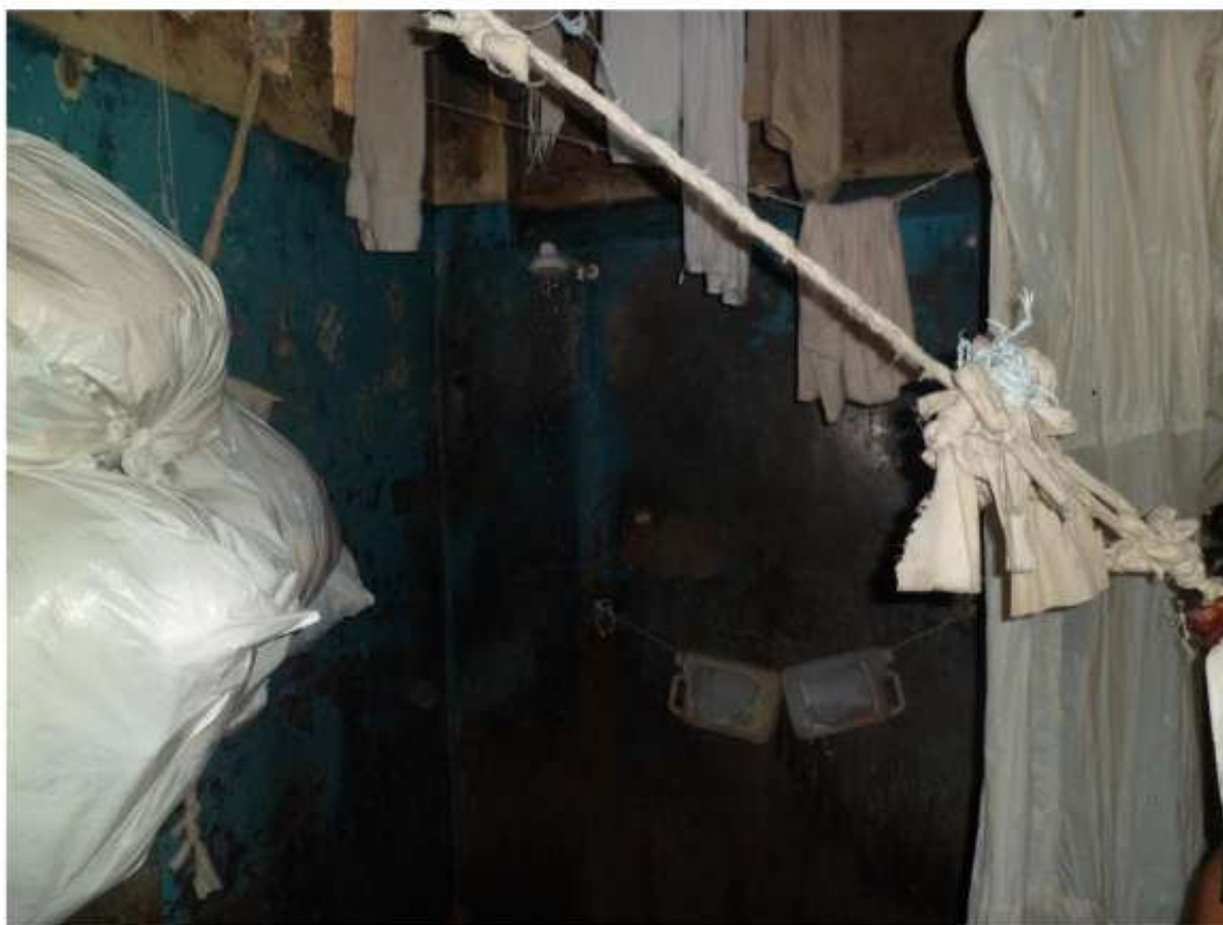
Cela em estado precário de salubridade
