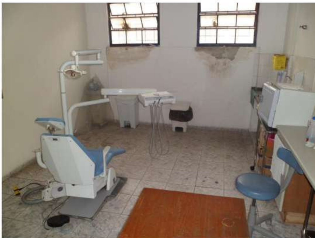
Sala de dentista em estado ruim
