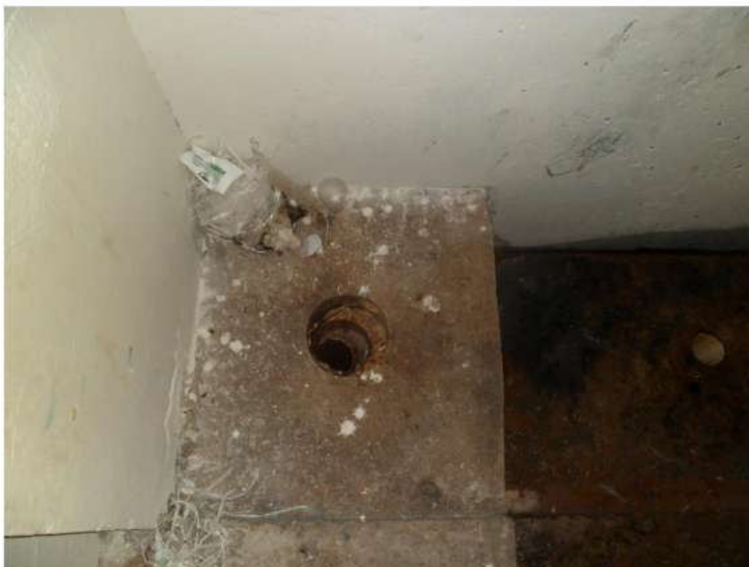
Precariedade das instalações da unidade
