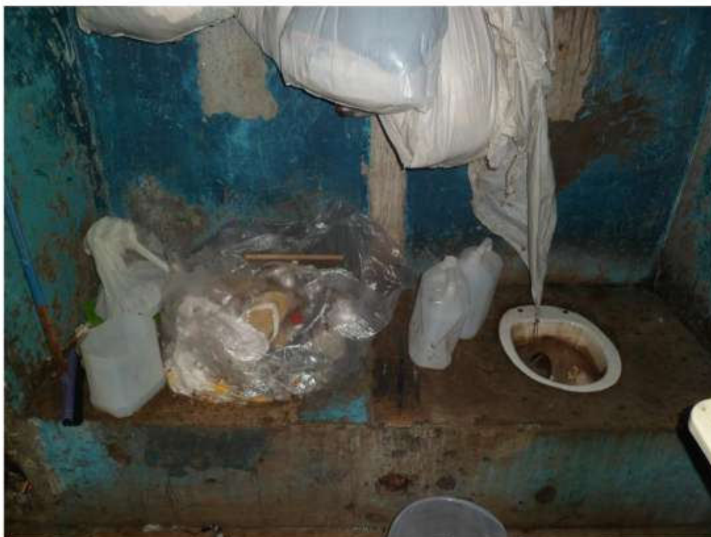
Situação precária do banheiro da cela
