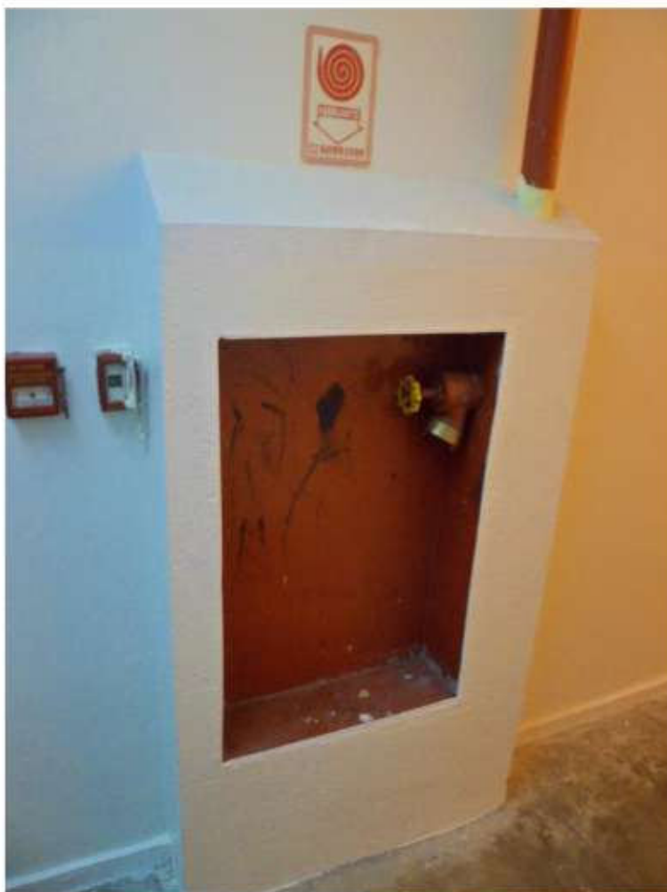
Irregularidade do sistema anti-incêndio
