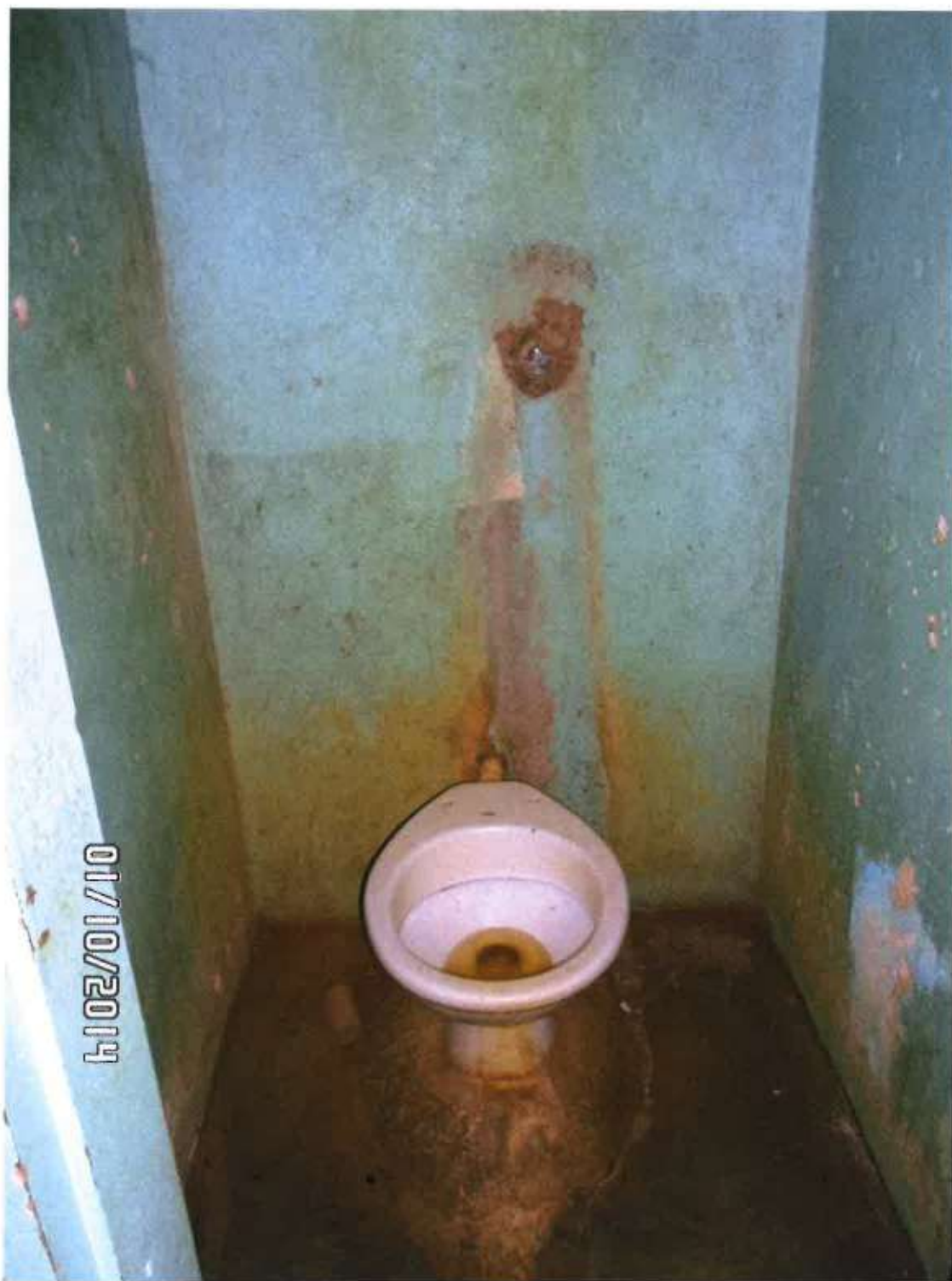
Banheiro do raio 02 usado pelas visitantes - Privada do banheiro utilizado pelas visitantes - precário
