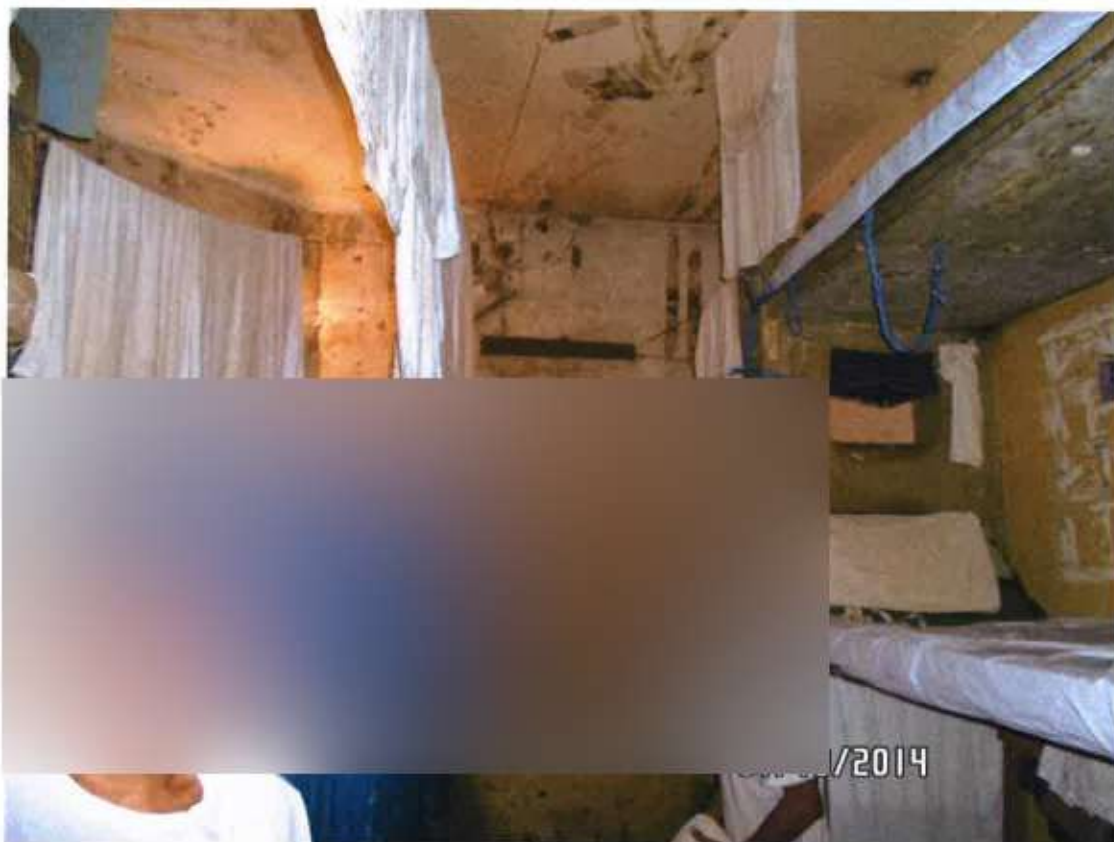
Cela do raio 2 - falta de iluminação
