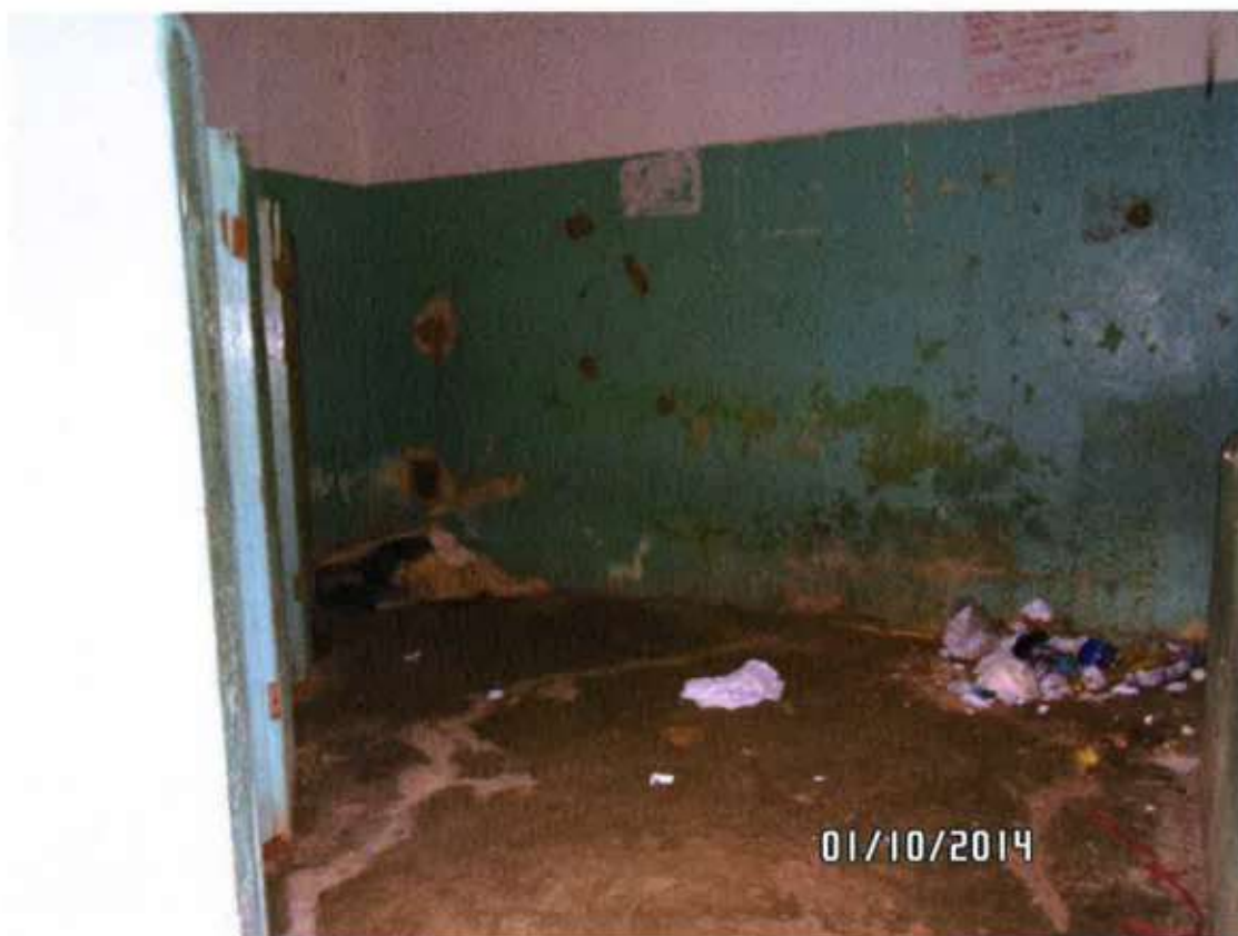
Banheiro do raio 02 usado pelas visitantes - sujeira
