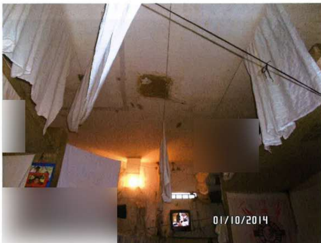
Cela superlotada do raio 2 - falta de ventilação, espaço e iluminação
