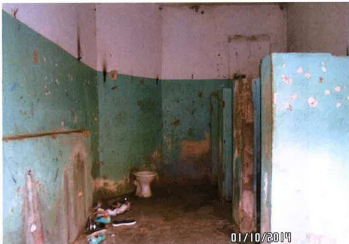
Banheiro do raio 02 usado pelos visitantes - sujeira
