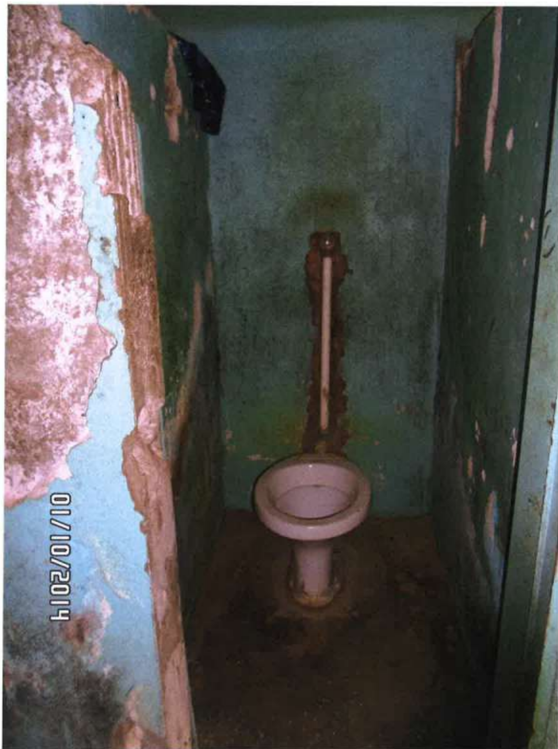
Banheiro do raio 02 usado pelos visitantes - Privada do banheiro utilizado pelos visitantes - precário
