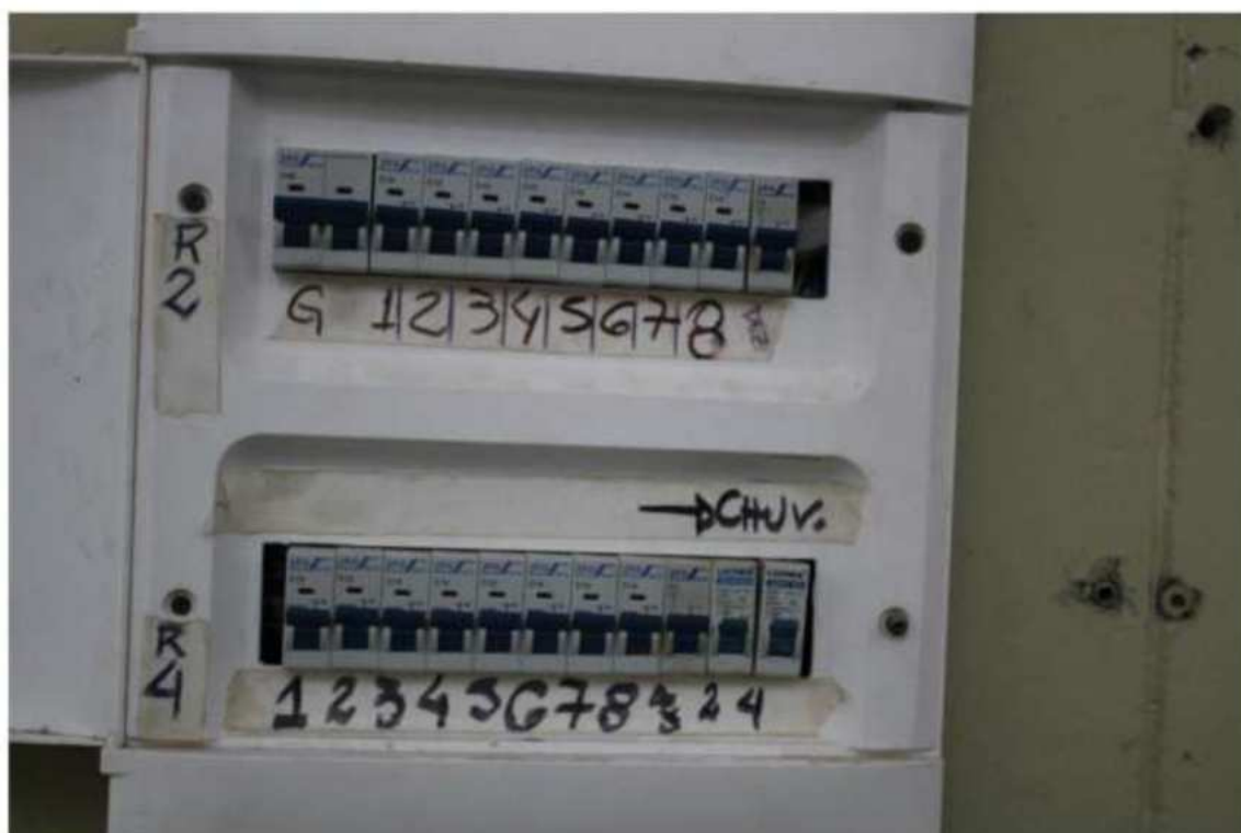
Disjuntores de aquecimento de chuveiros
