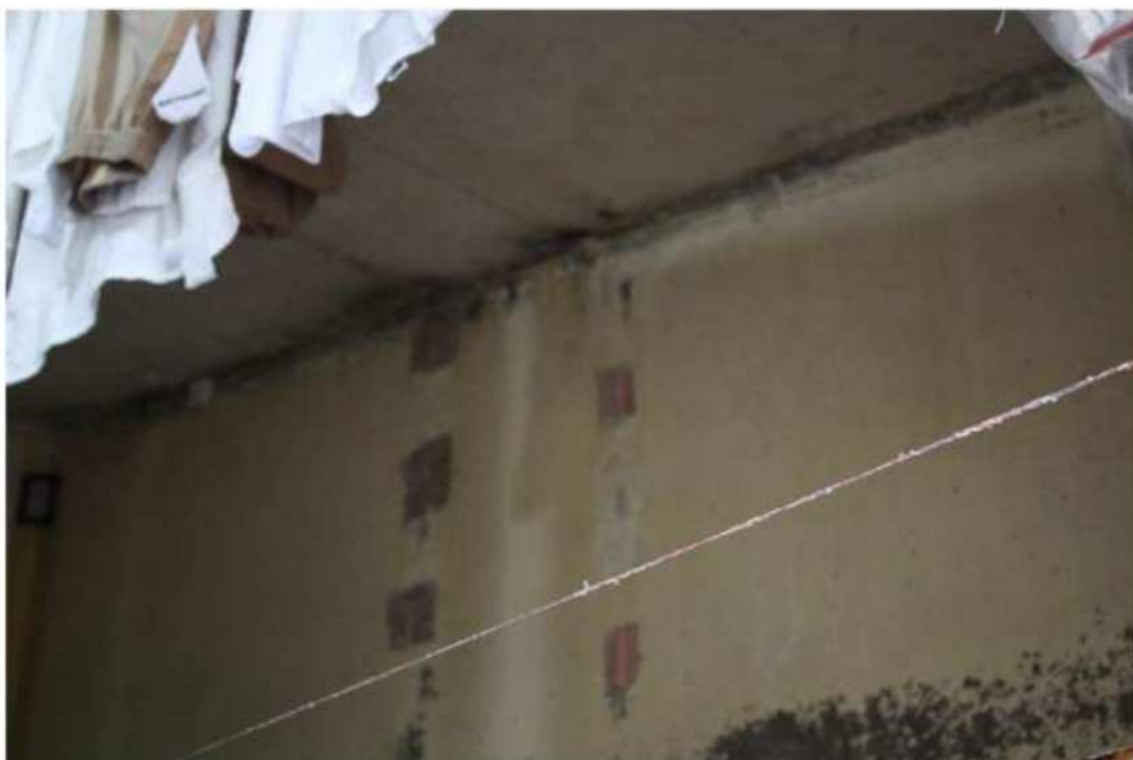
Infiltração no teto de celas
