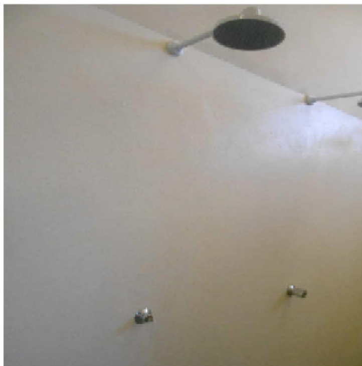
(Imagem de chuveiro com torneira quebrada)
