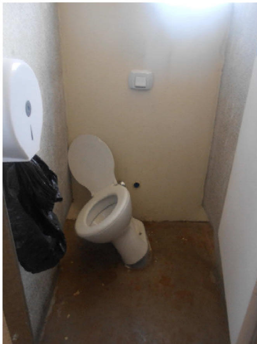
(Vaso sanitário quebrado)
