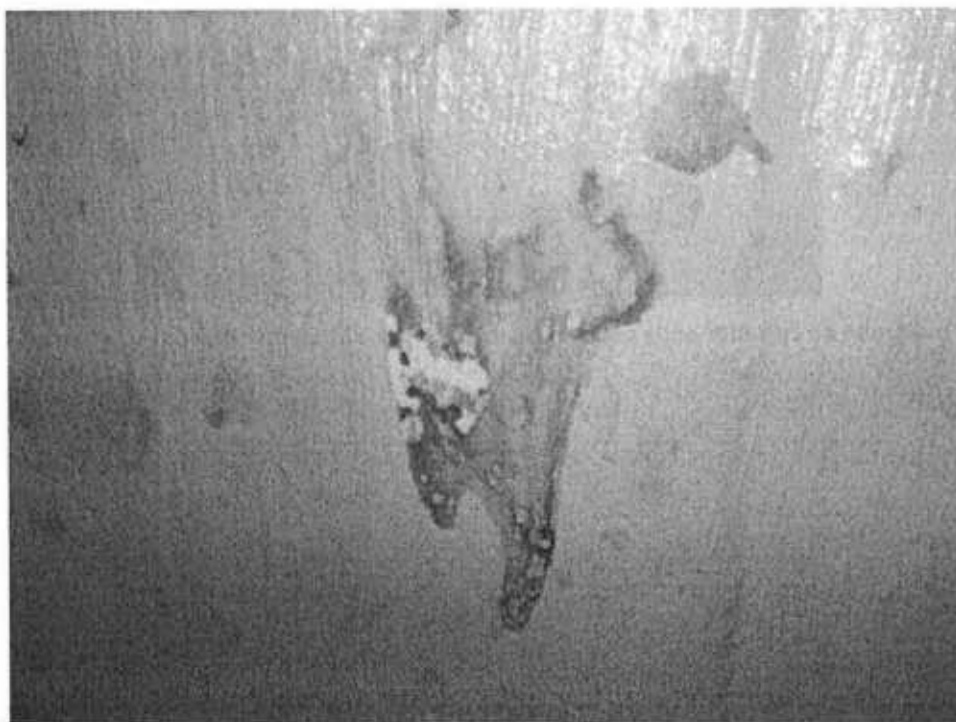
Parede do corredor onde estão localizadas as celas disciplinares, com supostas manchas de sangue
