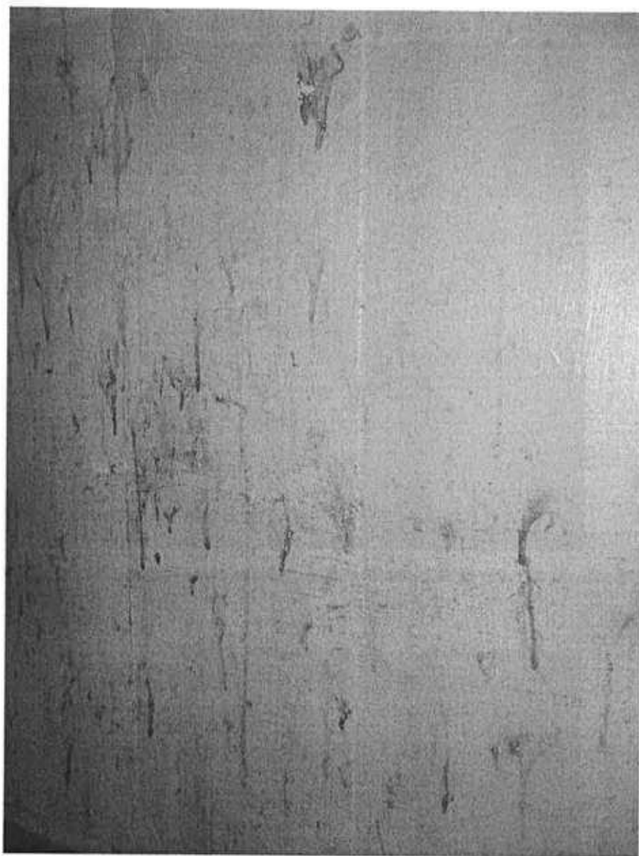
Parede do corredor onde estão localizadas as celas disciplinares, com supostas manchas de sangue
