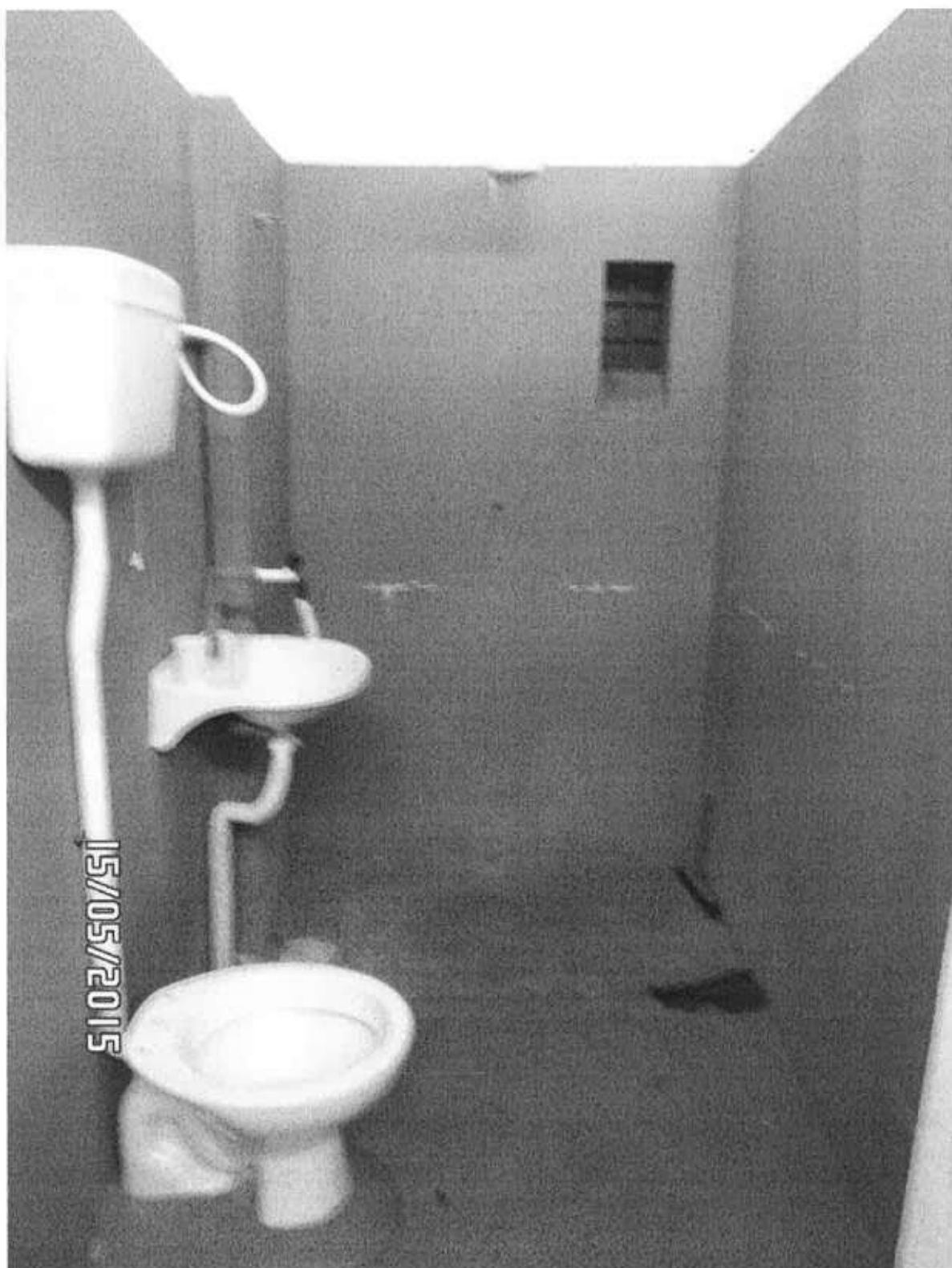
Banheiro da cela do pavilhão hospitalar
