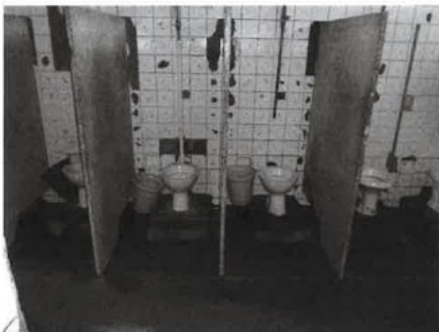
Vasos sanitários em mau estado de conservação e com higiene precária.
