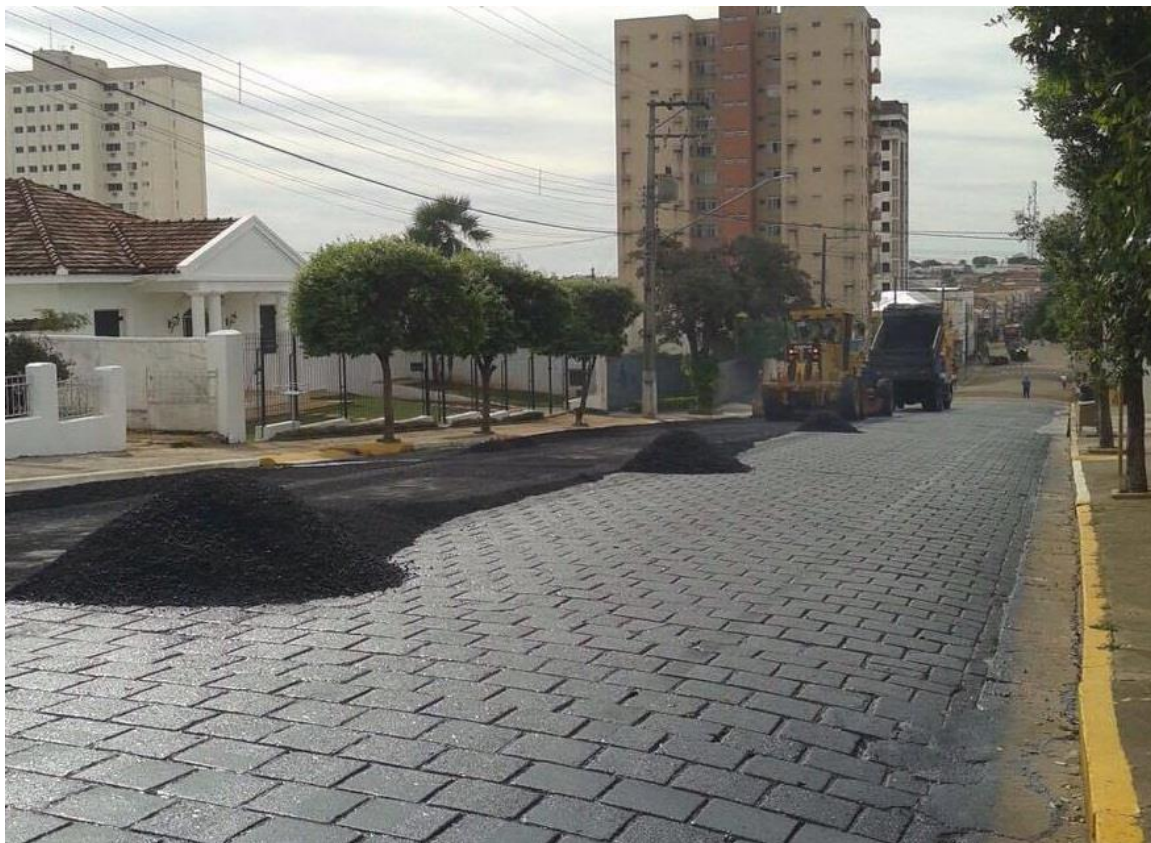
Figura 1: Avenida Dom Pedro II, no Centro de Presidente Venceslau, em processo de pavimentação (LUCHETE, 2017).
