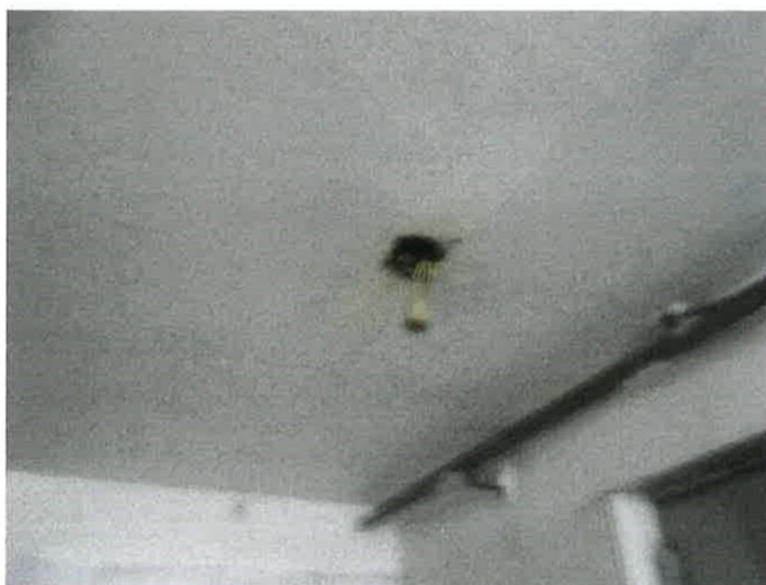
Falta de iluminação no corredor do setor disciplinar
