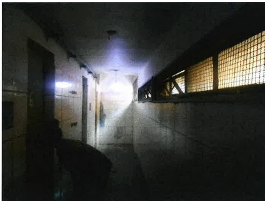
Detalhe do setor disciplinar – iluminação muito precária mesmo nos corredores (não há iluminação nas celas e há lâmpadas queimadas no corredor)
