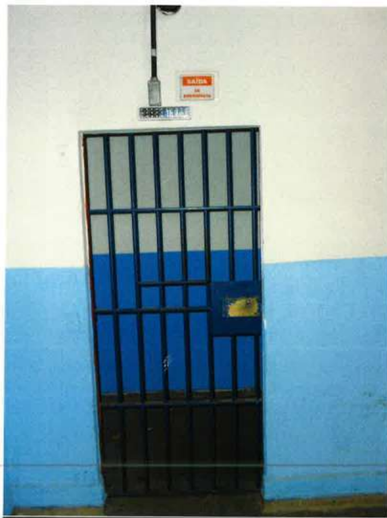
Acesso para a saída de emergência trancado.
