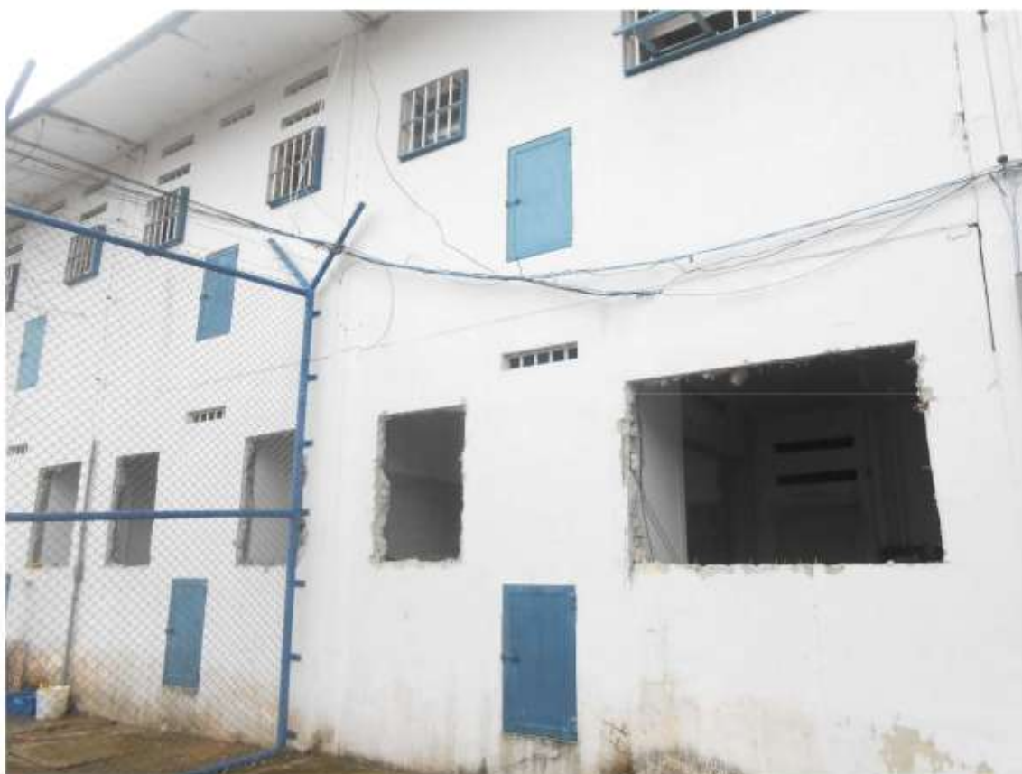
(Visão da parte externa da Enfermaria em reforma há 2 anos)
