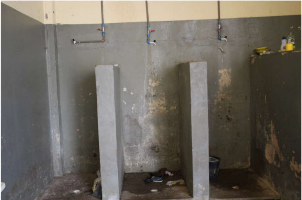
Saídas de água no pátio acopladas ao sistema externo de aquecimento
