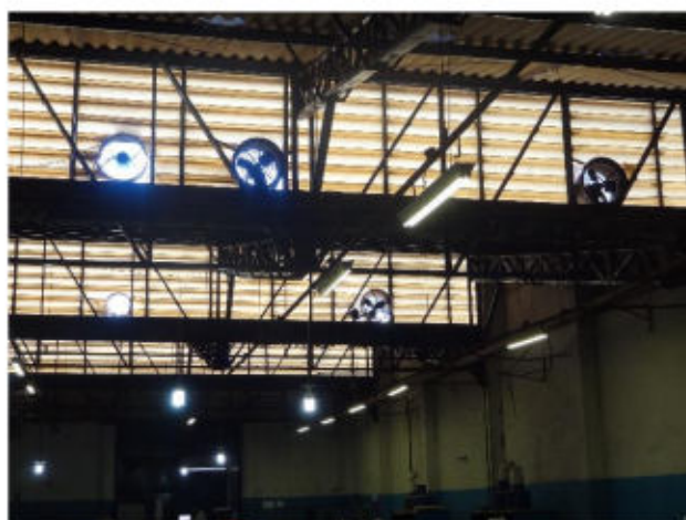
Ventiladores do local
