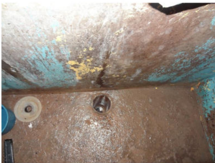
Ralo do chuveiro usado para as necessidades
