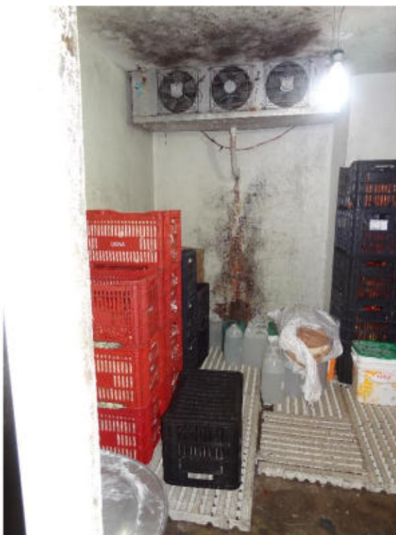
Paredes e teto da câmara fria manchados
