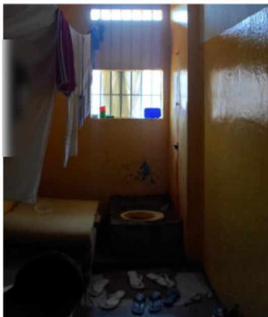
Ausência de chuveiro. Apenas o buraco na parede
