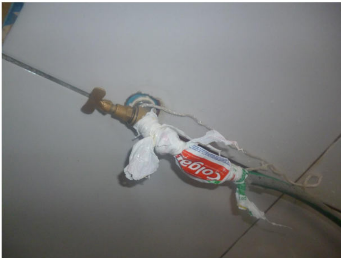
Falta de torneira
