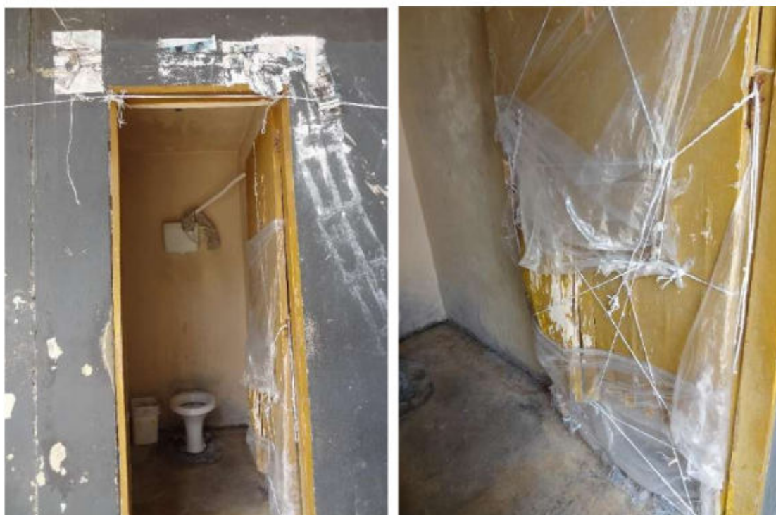
(porta do banheiro do pátio com a porta quebrada – banheiro que os familiares usam em dias de visita)
