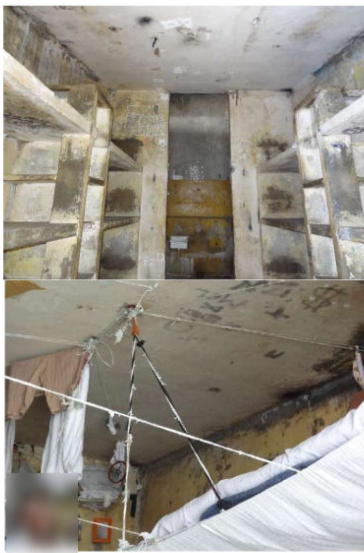
(celas com infiltração no teto e pasta de sabão para conter os vazamentos)
