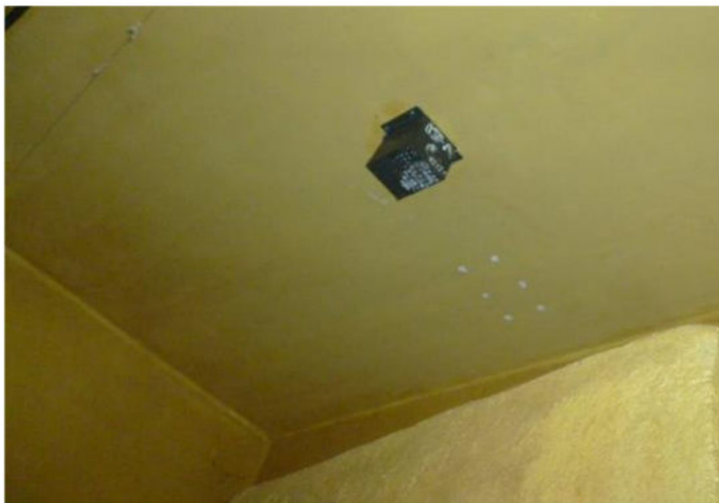
(cela desativada -há instalação elétrica, sem fios improvisados)
