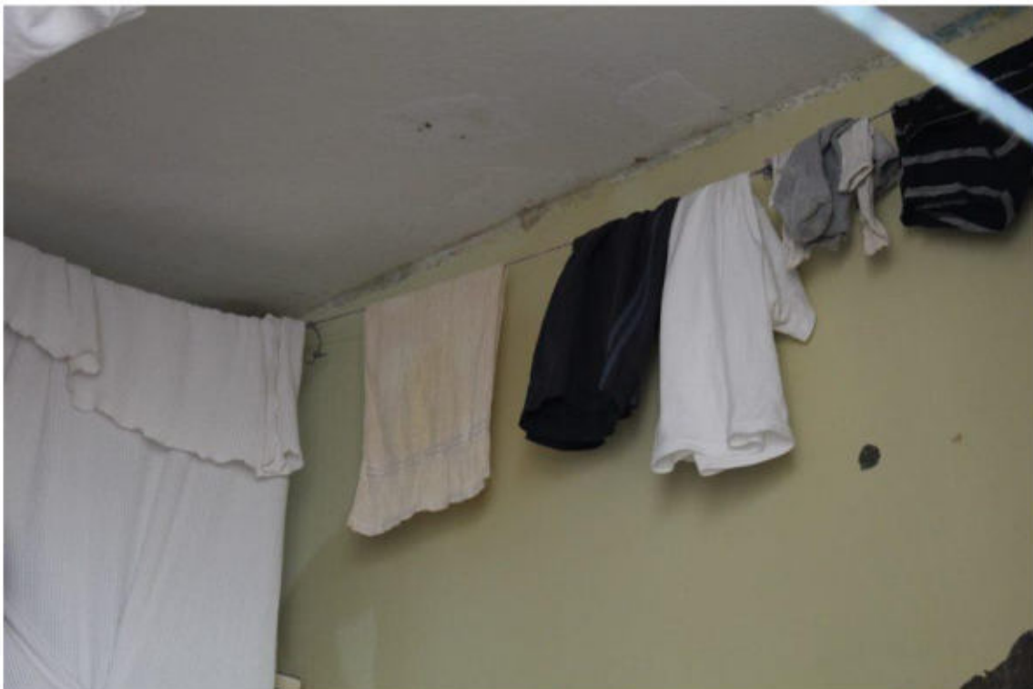
(Rachaduras nos tetos das celas)
