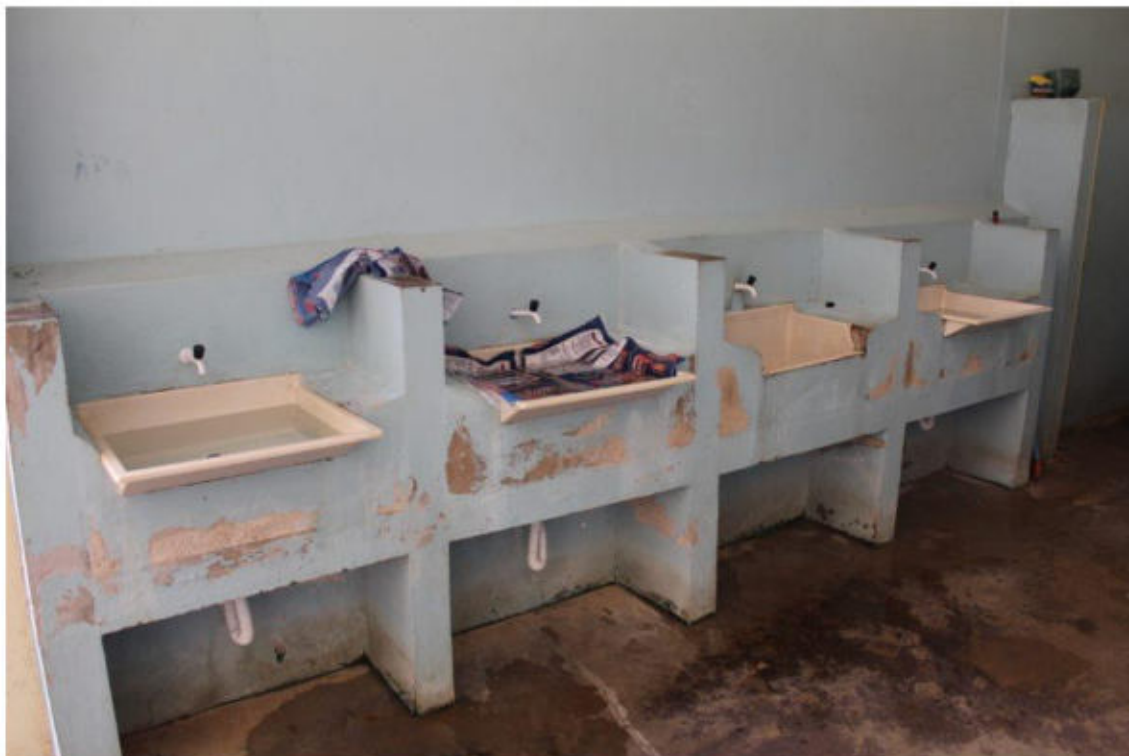
(Torneiras do pátio coletiva inutilizadas e entupidas)
