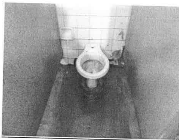
Foto 14: banheiro coletivo com único vaso sanitário funcionando.
