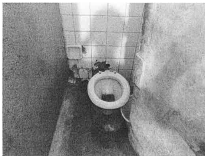
Foto 15: banheiro coletivo com vaso sanitário entupido.
