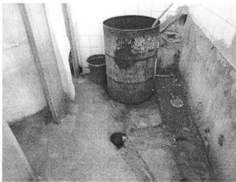
Foto 16: banheiro coletivo, com armazenamento de água improvisado e ralo sem qualquer tampa
