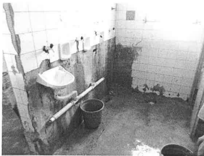
Foto 17: banheiro coletivo sem mictório e com encanamento/tubulação improvisada,
