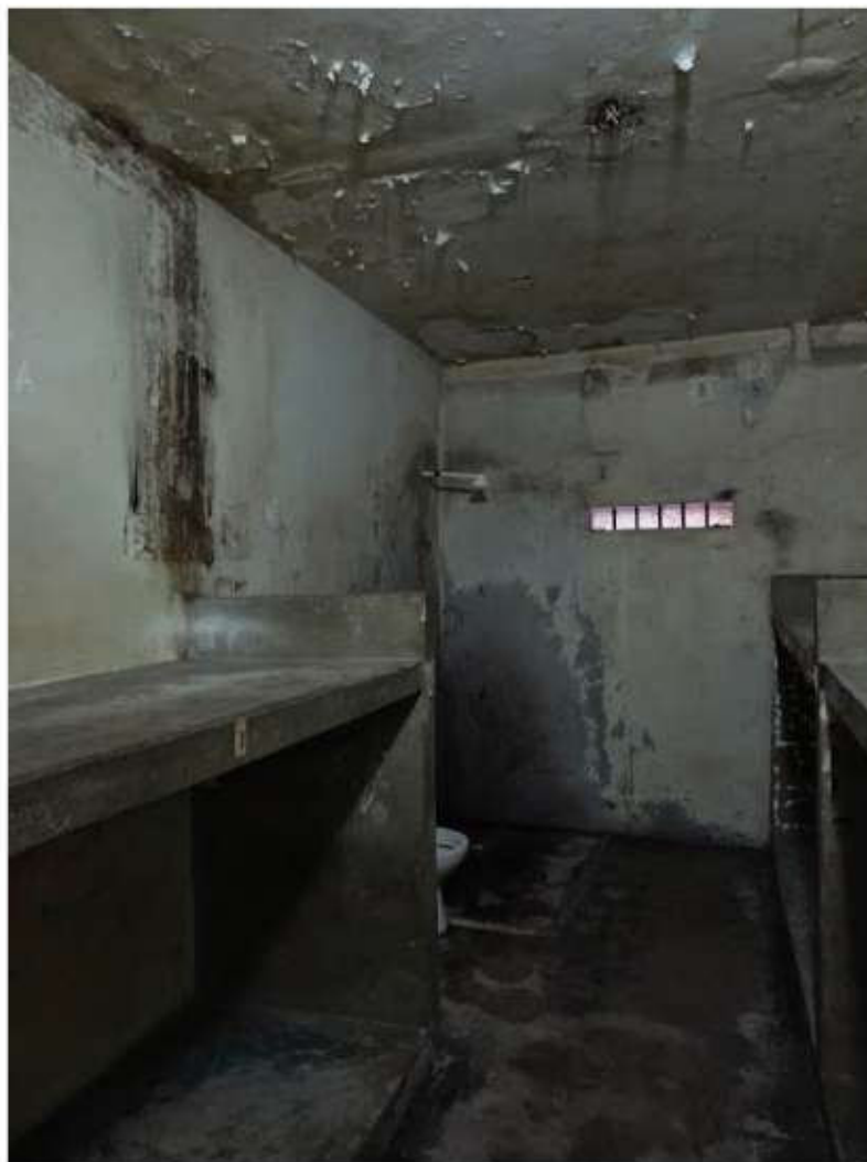
Cela do setor de inclusão, desocupada no dia da inspeção
