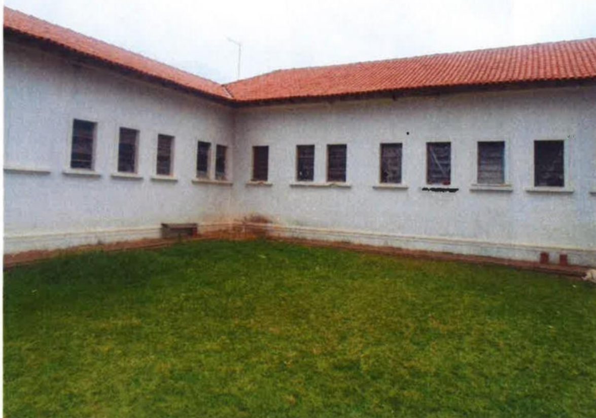
Foto 24 - Visão externa dos alojamentos, mostrando os vidros das janeladas quebrados.
