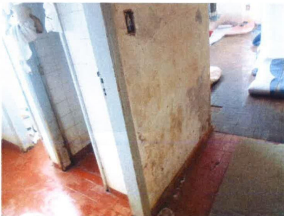
Foto 20 - Colchões à porta do banheiro.
