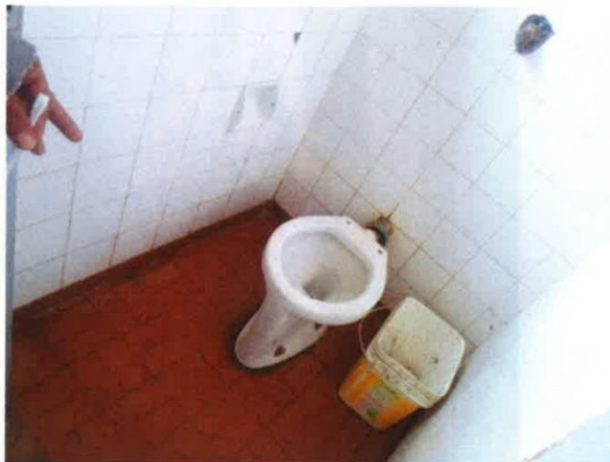
Foto 22 - Ausência de descarga. Balde para remoção de dejetos.
