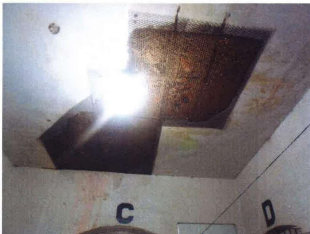
Foto 04 – Teto entre a entrada dos alojamentos C e D.
