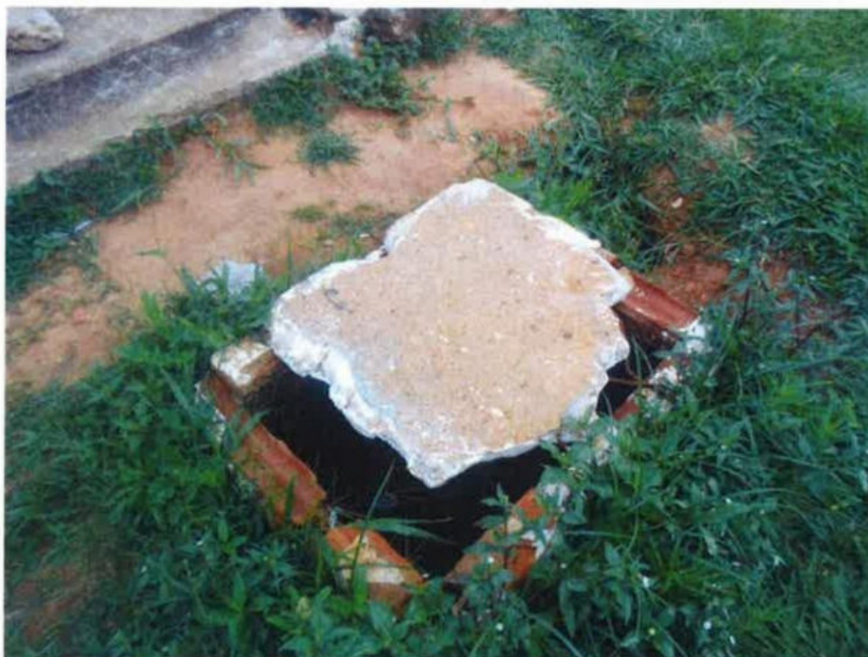
Foto 28 - Esgoto aberto. Tampa danificada.
