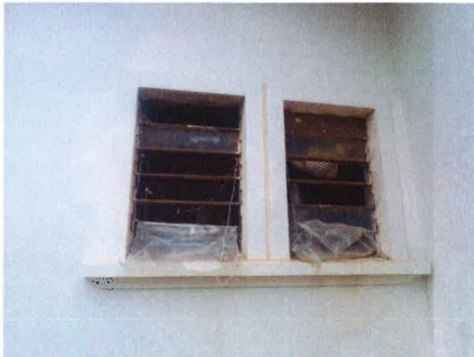
Foto 26 - Vidros das janelas danificados.
