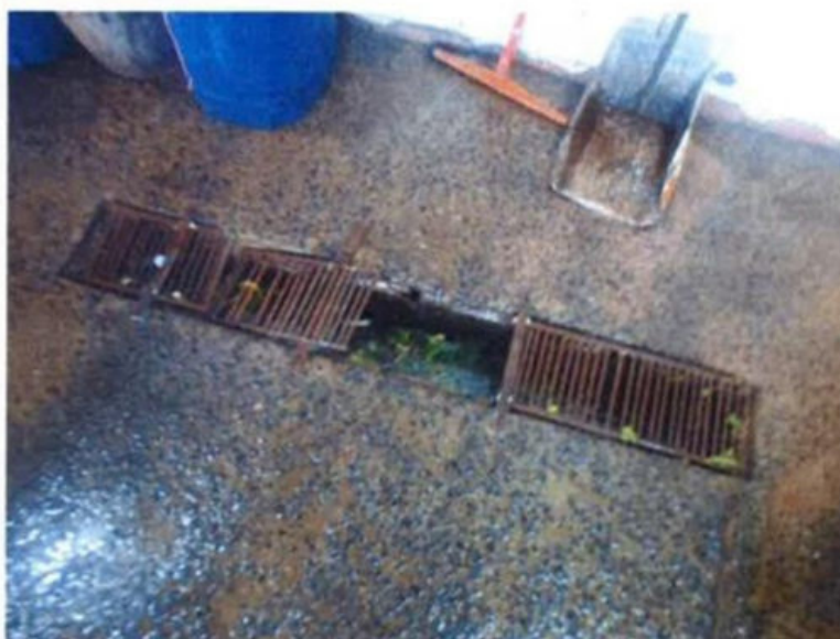
Foto 40 - Ralo aberto e quebrado na cozinha.
