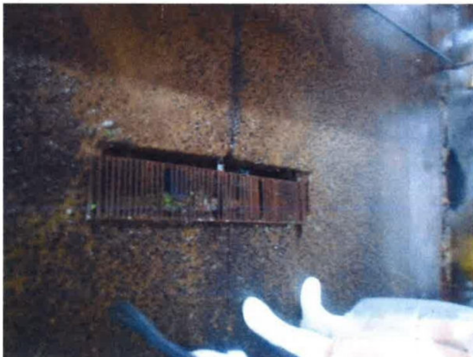
Foto 39 - Ralo aberto e quebrado na cozinha.
