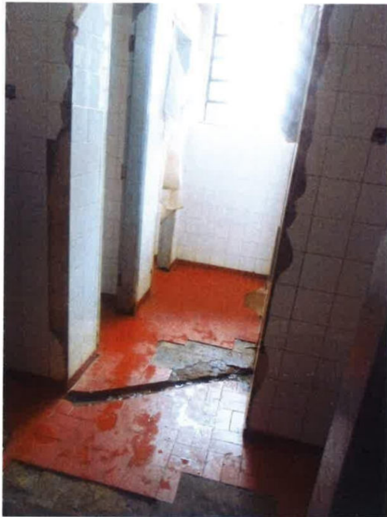
Foto 21 - Piso do banheiro quebrado, facilitando o acumula de sujeira e bichos.
