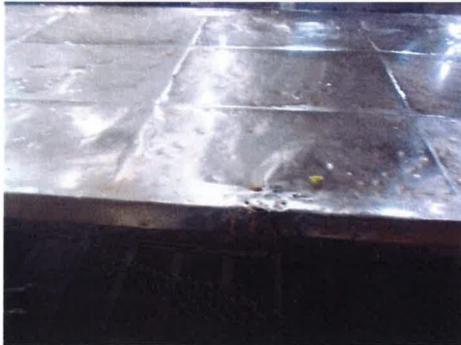
Foto 38 - Grade quebrada em mesa do setor da cozinha.
