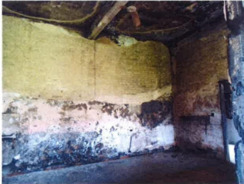
Foto 46 - Pavilhão danificado pelo incêndio 2
