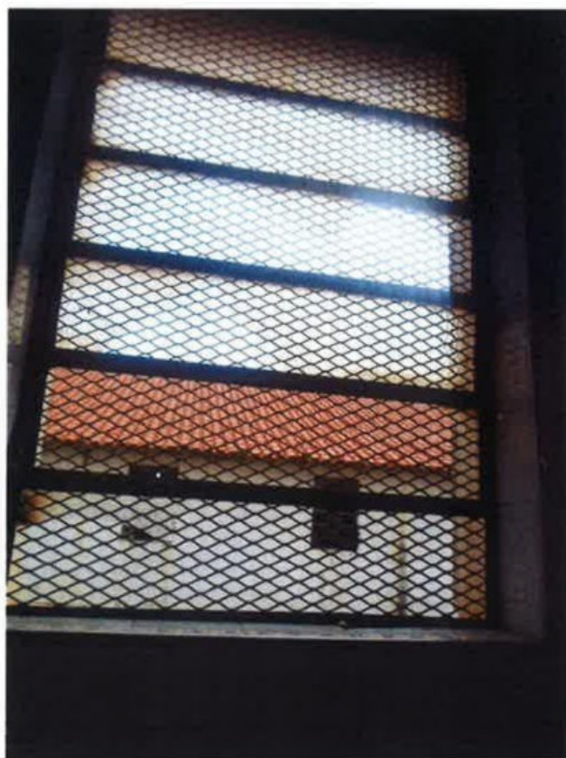
Foto 16 - Vidros quebrados do alojamento.
