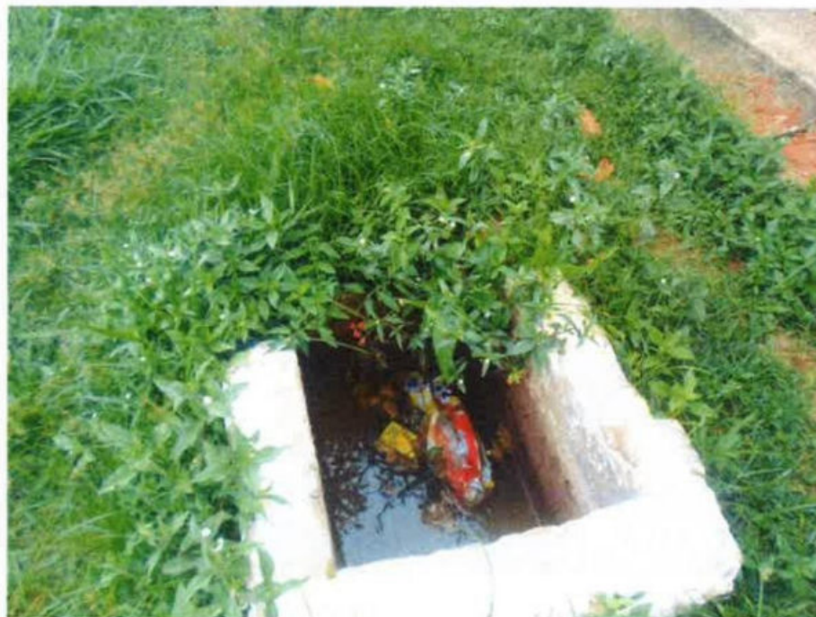
Foto 29 - Esgoto aberto. Ausência de tampa.
