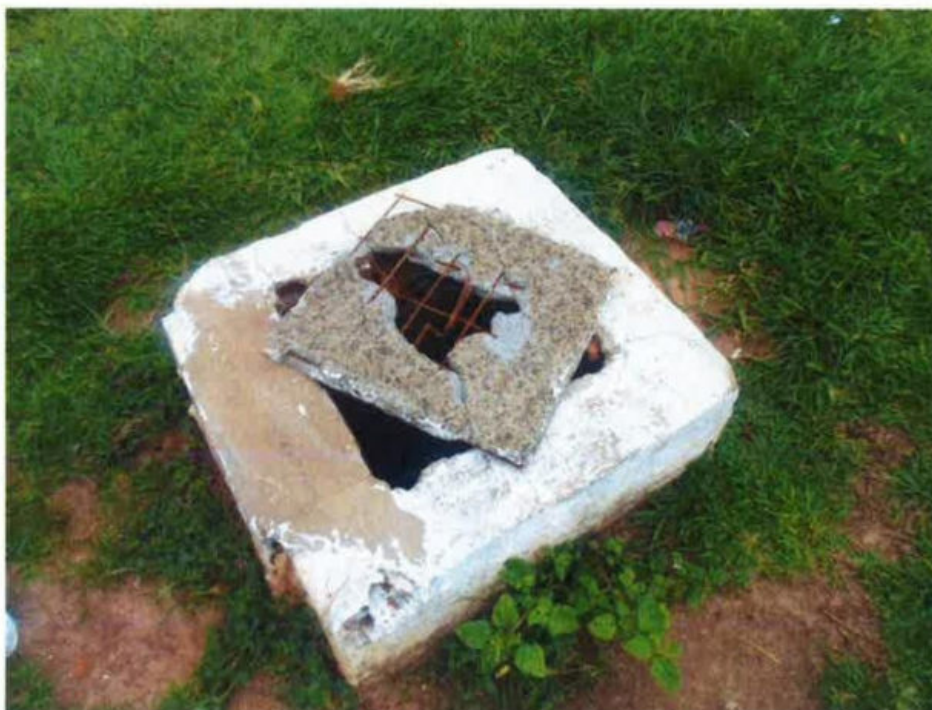
Foto 27 - Esgoto aberto. Tampa danificada.
