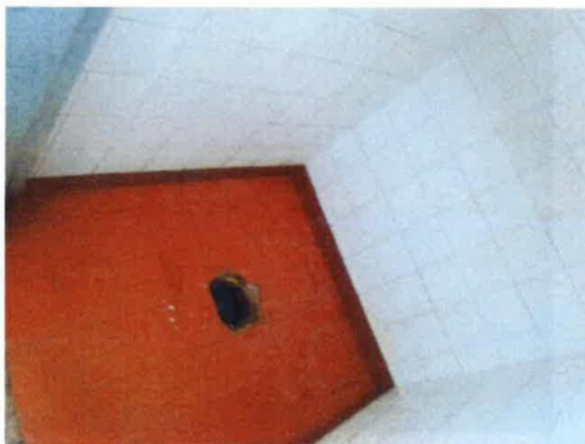
Foto 17 - Fosso no banheiro do alojamento.
