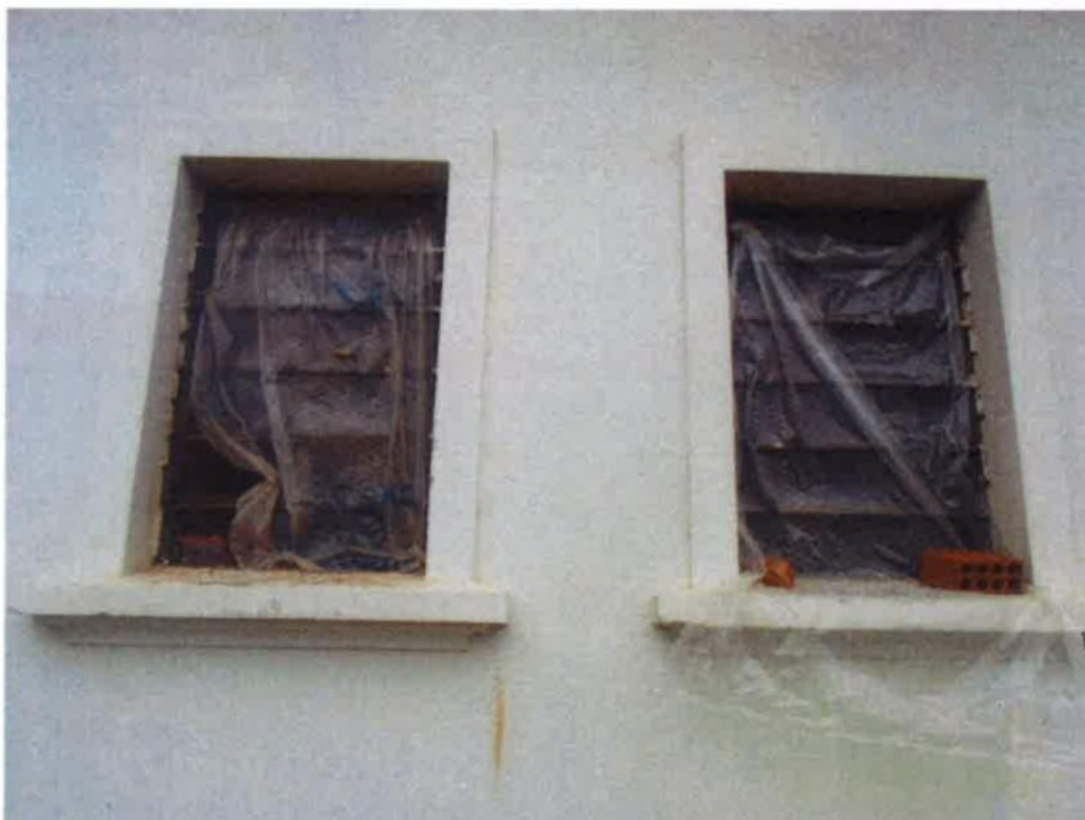
Foto 25 - Visão externa dos alojamentos, mostrando janelas cobertas com plástico devido à falta de vidros.
