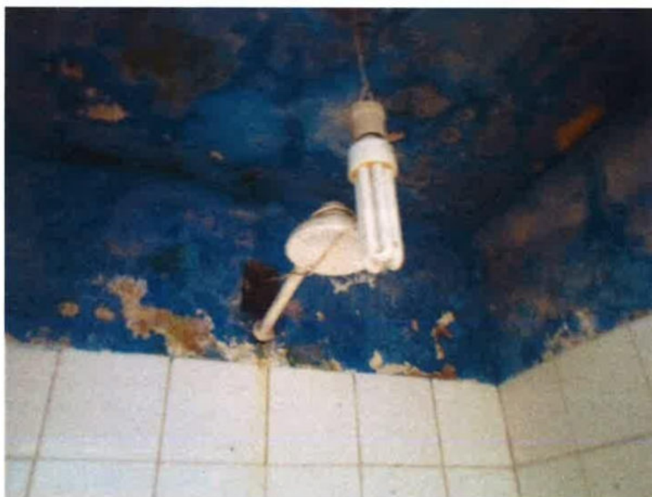
Foto 23 - Precariedade do chuveiro, amarrado por corda e lâmpada ao lado do chuveiro, possibilitando acidente elétrico.
