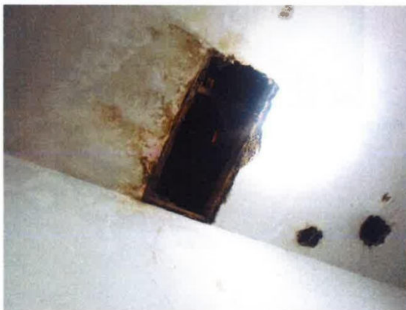
Foto 05 - Buracos no teto no interior do alojamento.
