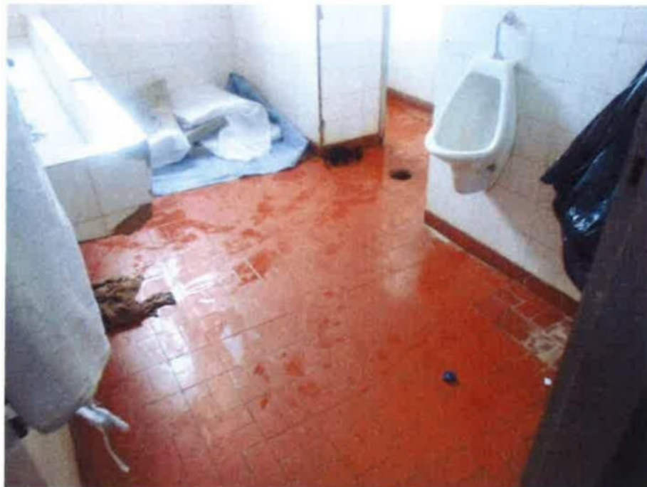
Foto 19 - Colchões no banheiro. Ralo aberto.
