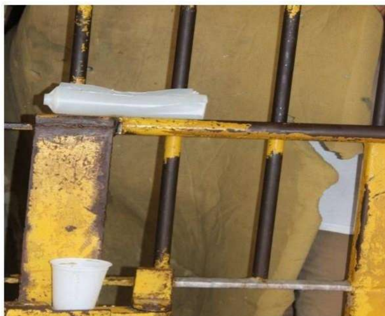
(Estado precário do colchão em uso)
