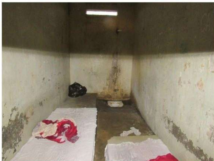
(Situação Precária das celas do "castigo" – foto com flash)
