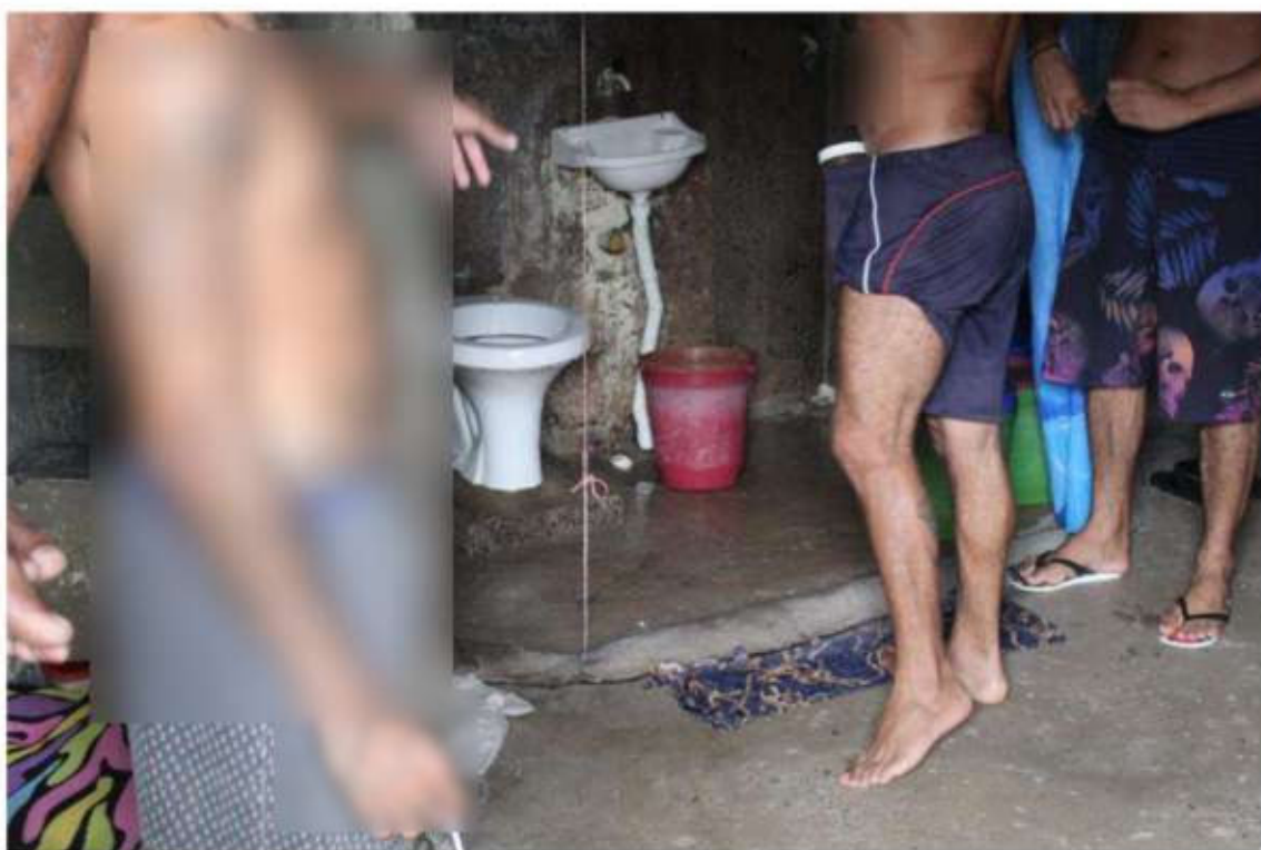
(Sifão da pia da cela quebrado e chão alagado)
