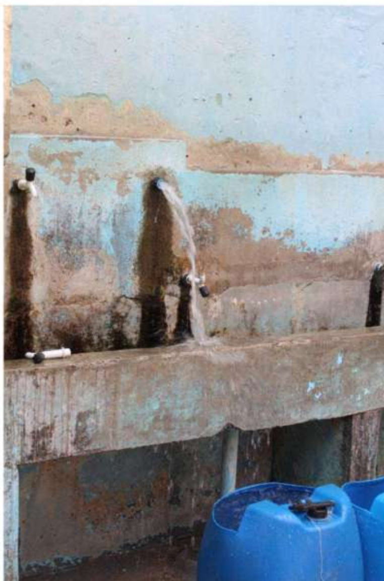
(Vazamento no tanque do Pavilhão 1)
