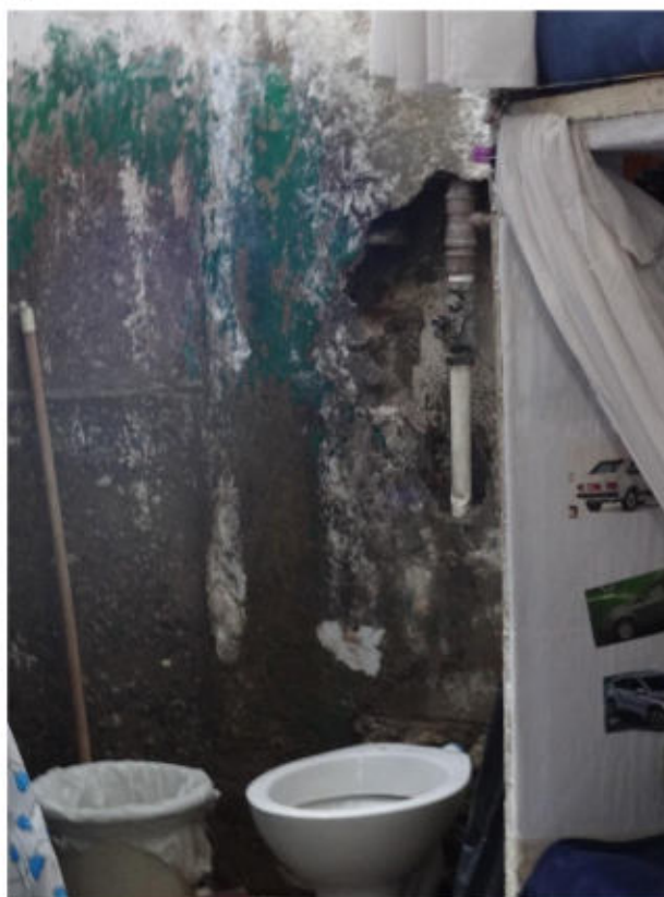
A parede atrás do chuveiro e sanitário é oca
