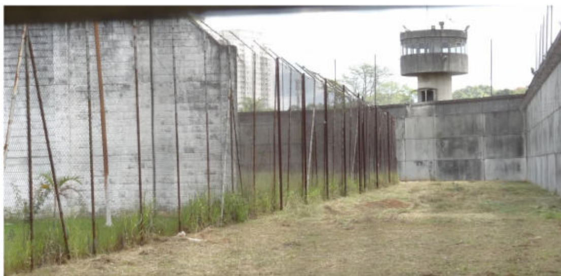
Estado do alambrado que cerca as quadras externas
