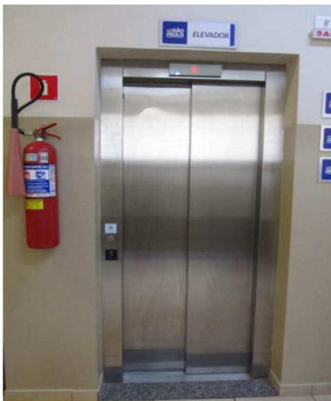
Elevador instalado na área administrativa da unidade
