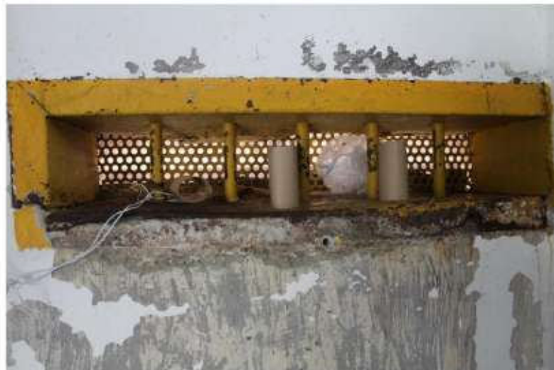
Detalhe de uma claraboia parcialmente fechada que impede a ventilação natural
