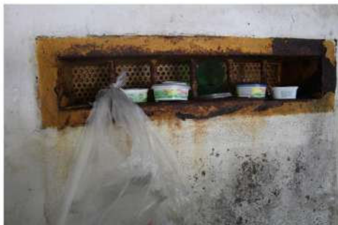
Detalhe de janela permanentemente fechada
