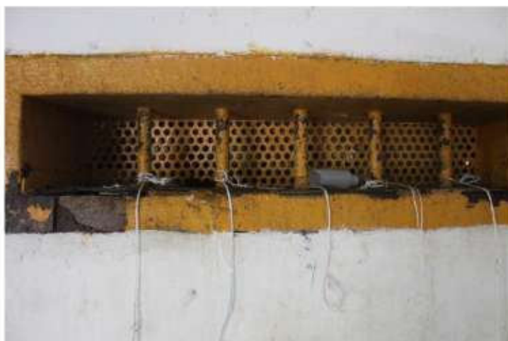
Detalhe de janela permanentemente fechada
