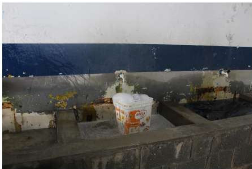
Torneira com vazamento no banheiro comum do pátio
