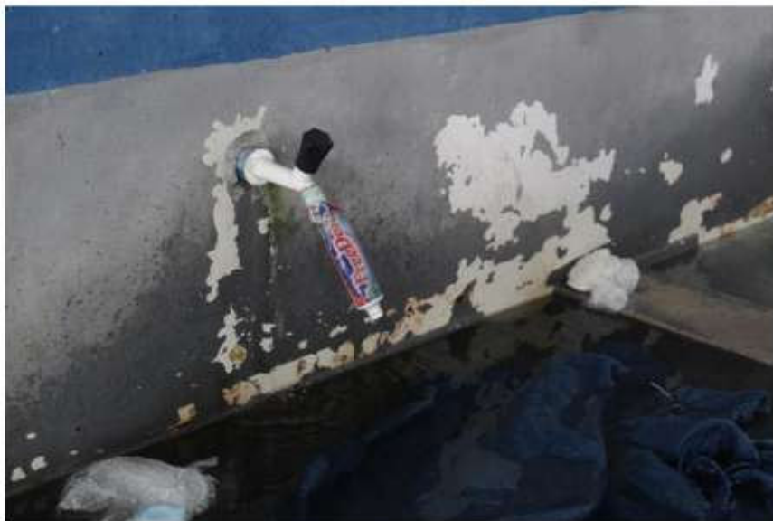
Exemplo de torneira quebrada no banheiro comum do pátio
