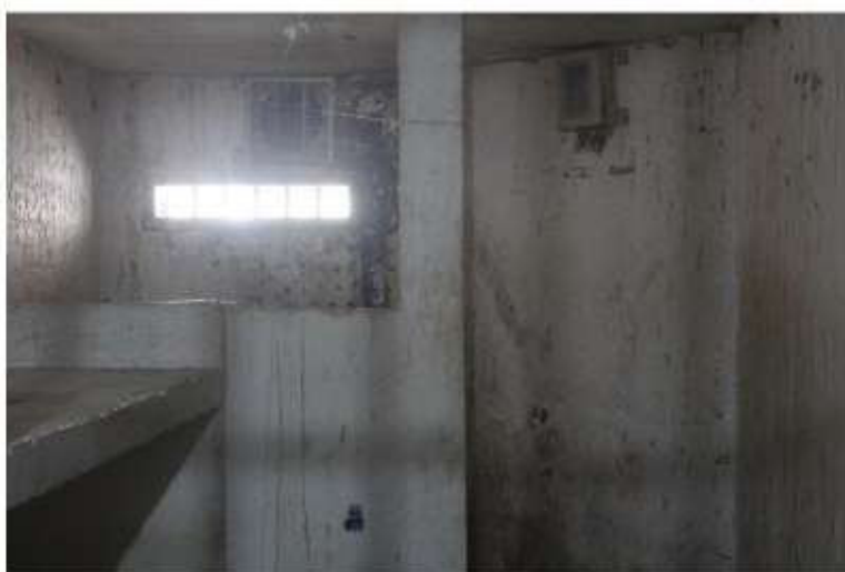
Detalhe para a ventilação e iluminação precária da cela radial
