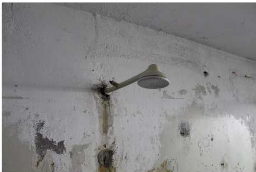
Chuveiro quente quebrado
