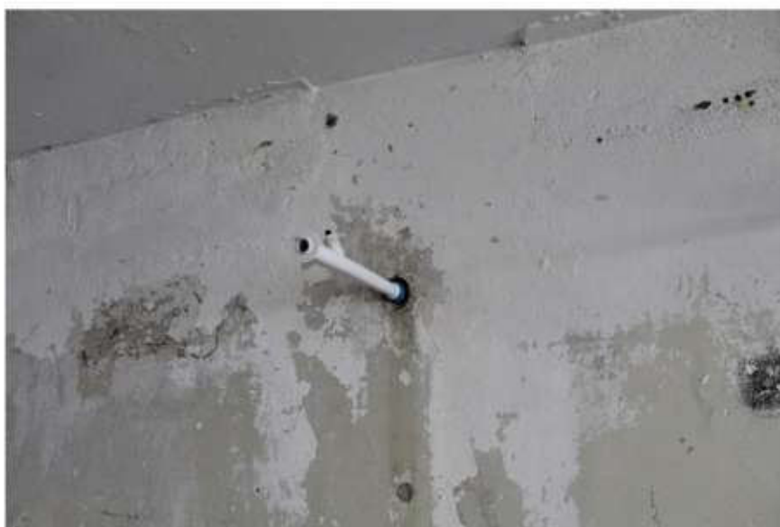
Chuveiro quente quebrado
