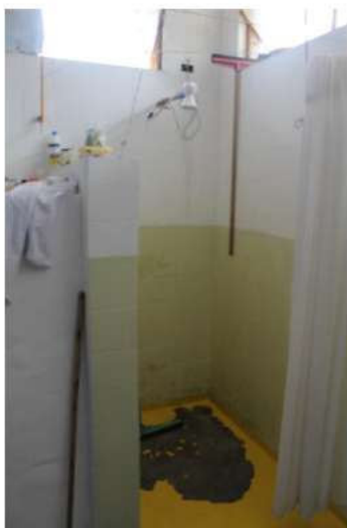
Chuveiro elétrico da ala de progressão penitenciária
