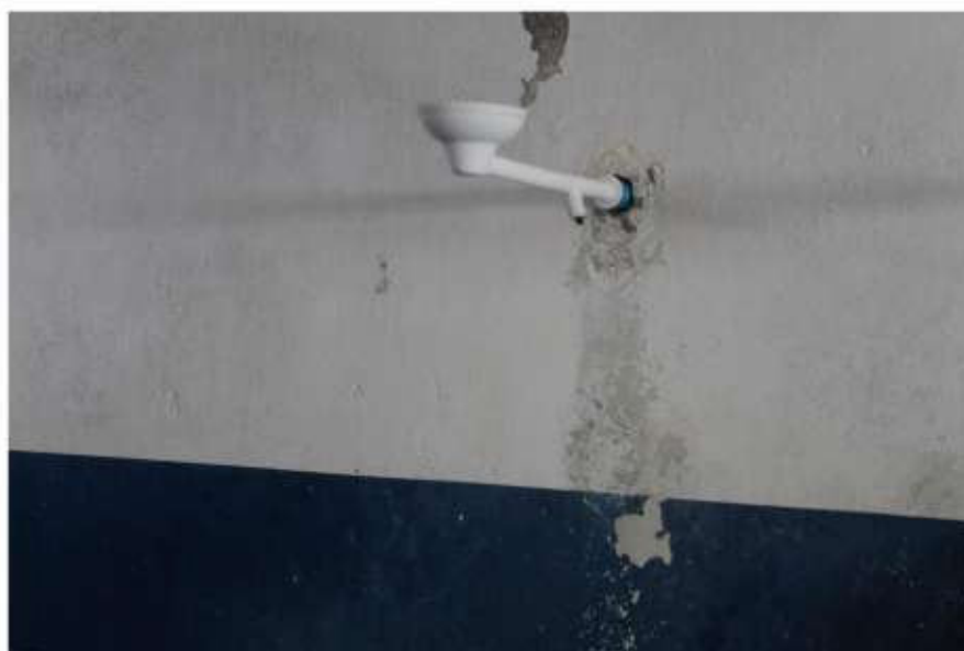
Detalhe para o chuveiro sem funcionamento
