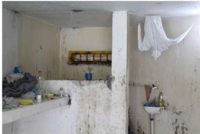
Detalhe de janela parcialmente fechada que impede a ventilação natural
