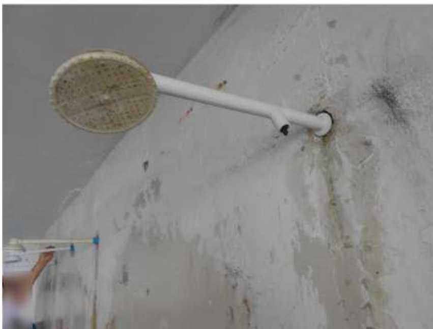
Chuveiro quente recém instalado em péssimas condições e já sem registro para abertura da água
