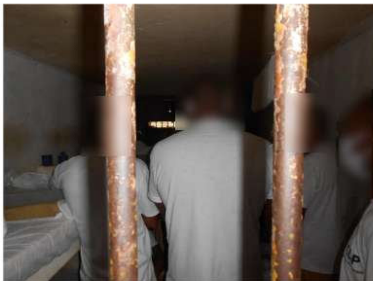
Detalhe para a falta de iluminação na cela radial
