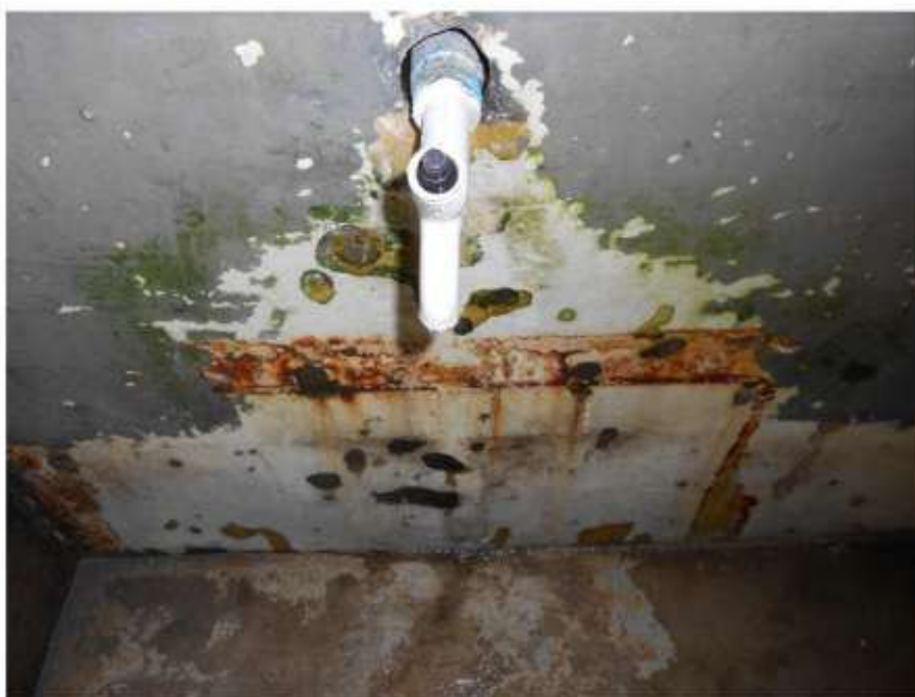
Exemplo de torneira quebrada no banheiro comum do pátio
