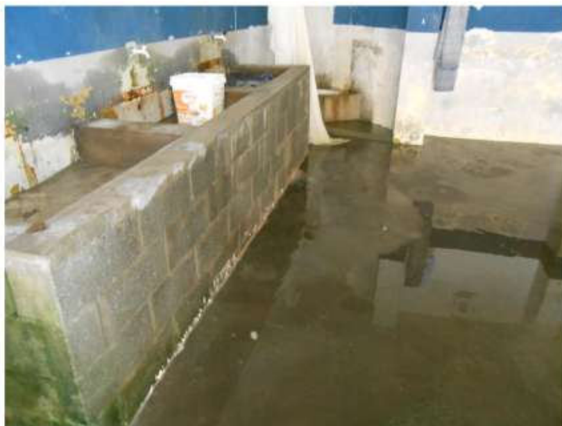
Foto do banheiro do pátio que no momento da visita possuía diversas torneiras com vazamento (detalhe para o piso alagado)
