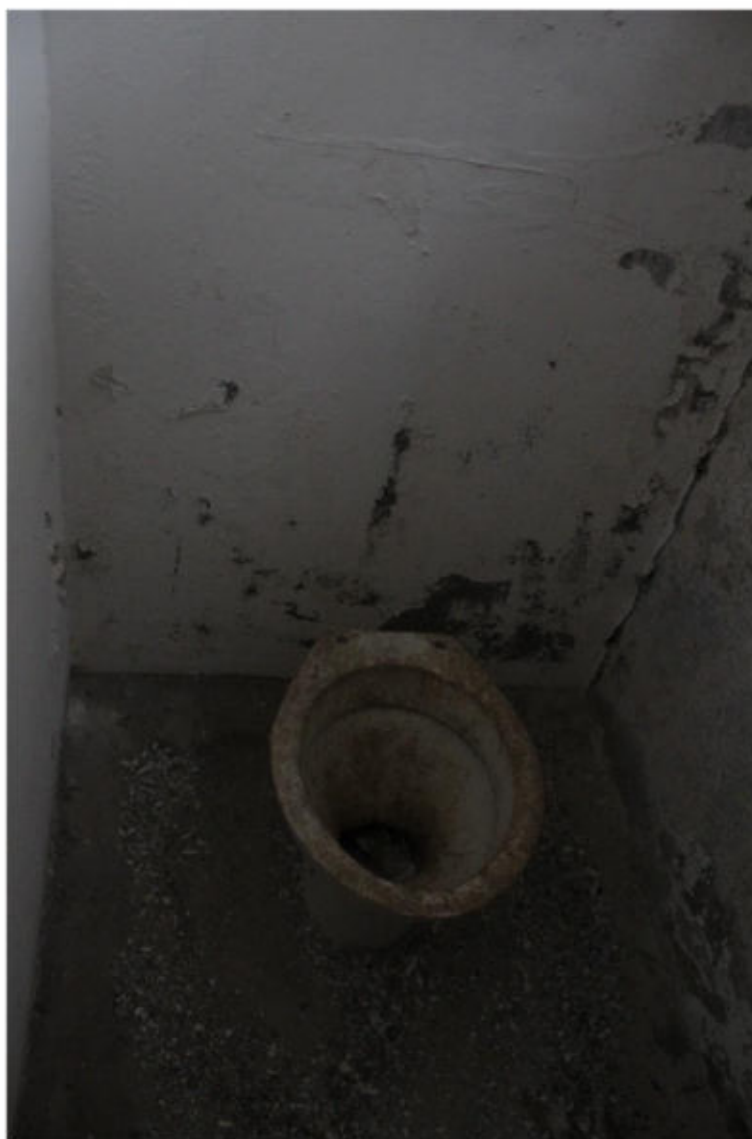
(Vaso sanitário sem condições de uso)
