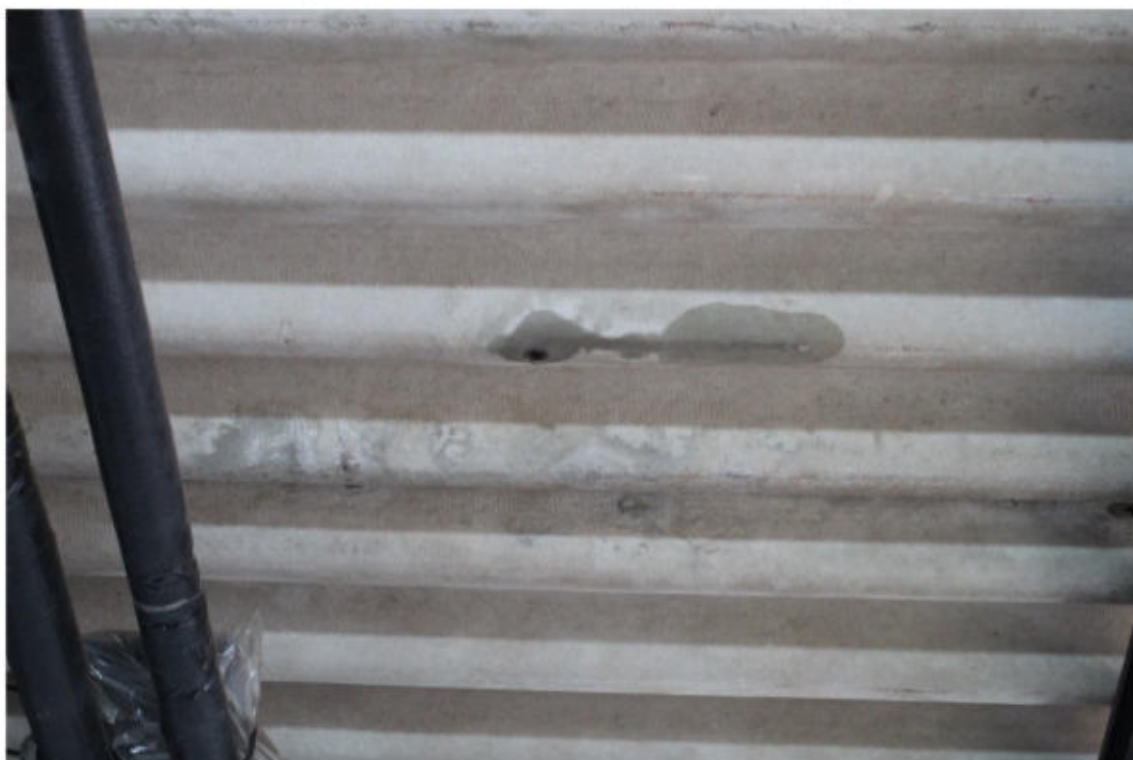
(Cobertura de corredor da unidade com infiltração)
