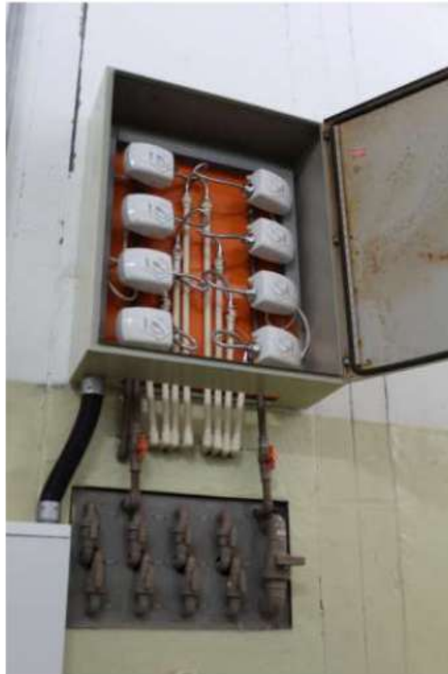
Figura 4 aquecedor instalado para dois raios, sendo 04 chuveiros para cada.
