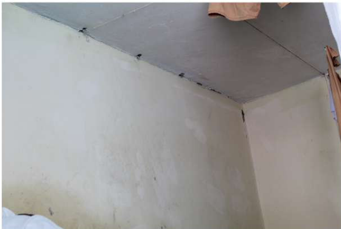
(Buracos no teto da cela, causando infiltrações)
