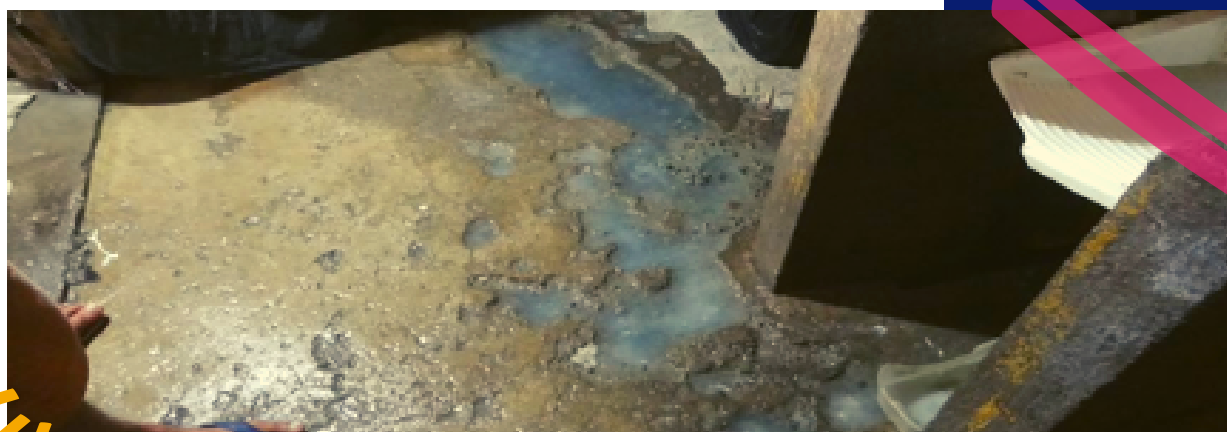
Foto 29 – CDP Masculino de São Vicente – 3/3/21 – Água subindo pelo chão, várias poças no banheiro de uma das celas.
