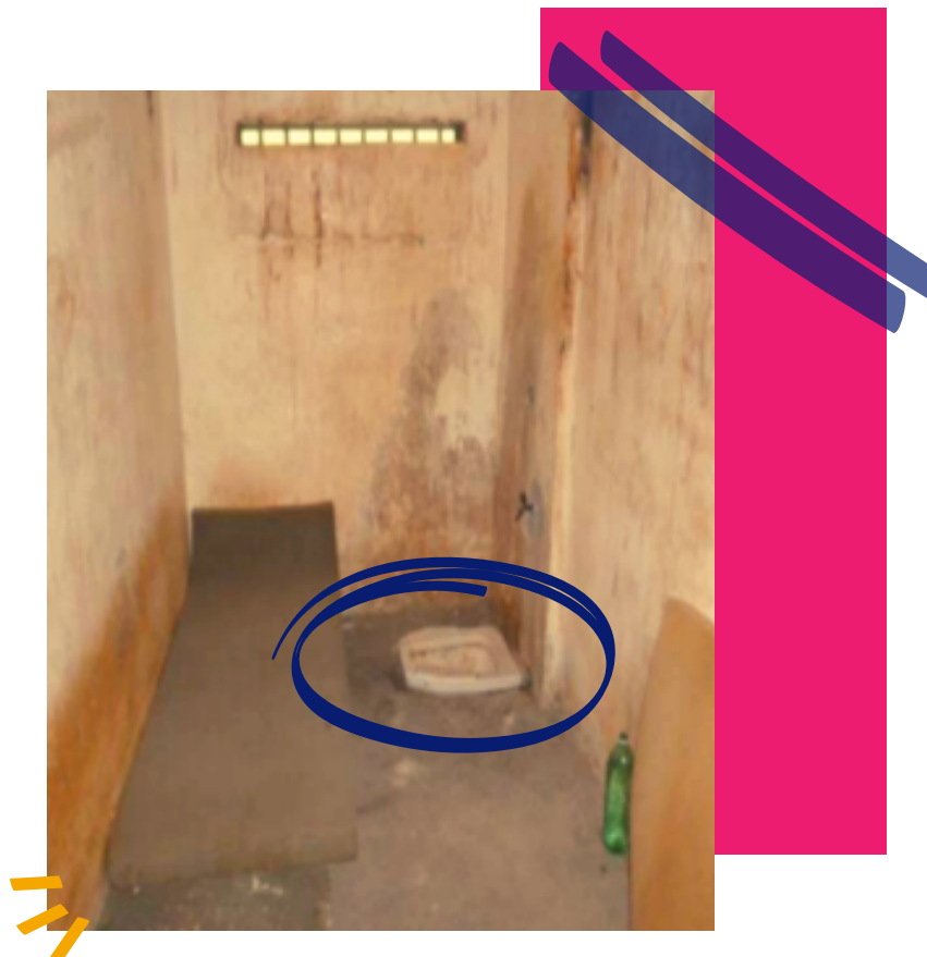
Foto 23 – CDP Masculino de Americana – 26/02/2021 – Cella imunda, insalubre, com diversas infiltrações nas paredes e “vaso turco”.
