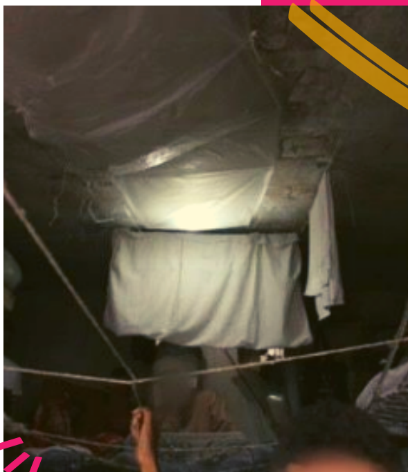
Foto 31 – CDP Masculino de Limeira – 18/12/2020 – Água vazando no banheiro do teto e plásticos improvisados para as pessoas se molharem o menos possível.
