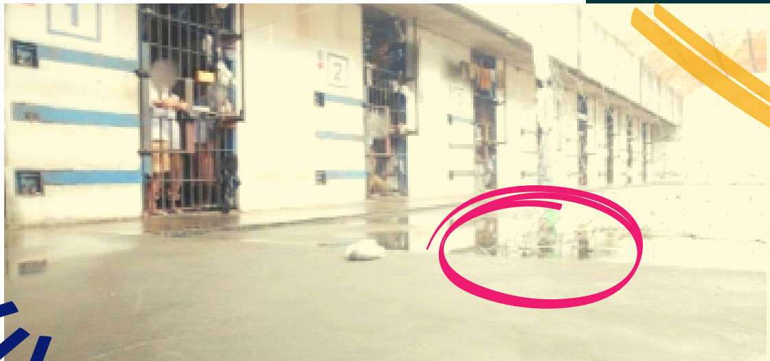
Foto 32 – CDP Masculino de Caraguatatuba – 05/03/2021 – Áreas alagadas no pátio na entrada das celas.
