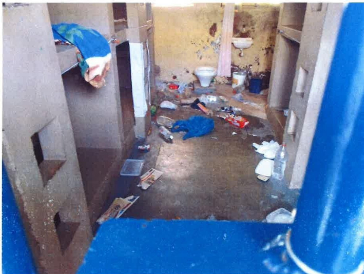
Foto 4: estado de insalubridade de uma das celas do pavilhão
