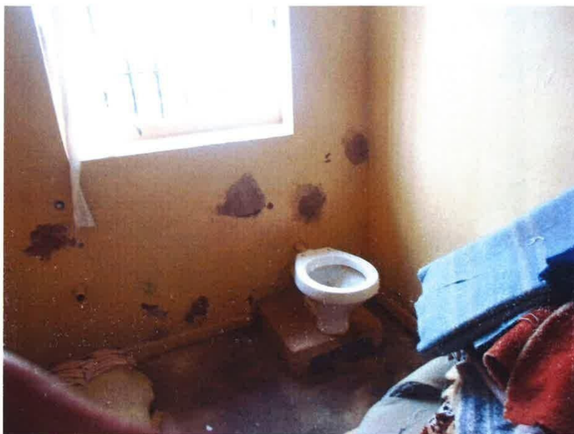
Foto 2- banheiro ao lado de colchões e camas.
