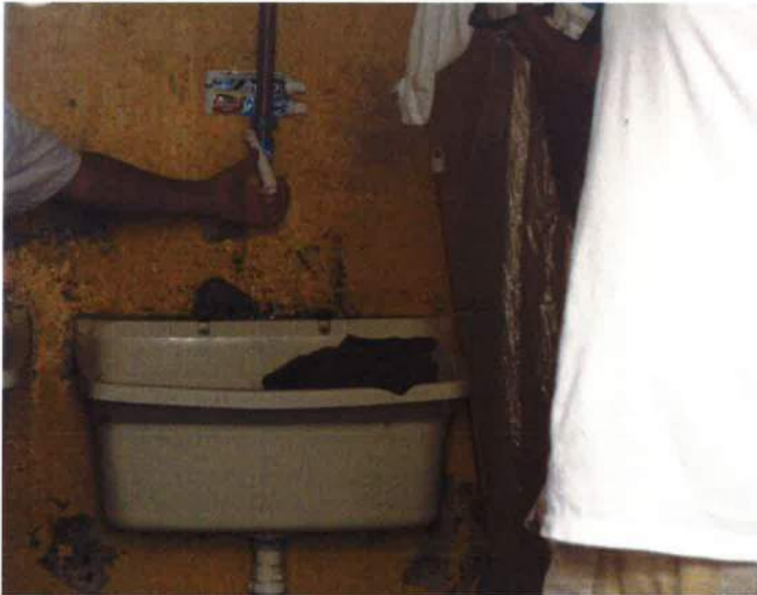
Péssimas condições sanitárias nas celas do raio 8, com pias sem torneira, vasos sanitários quebrados e falta d'água.
