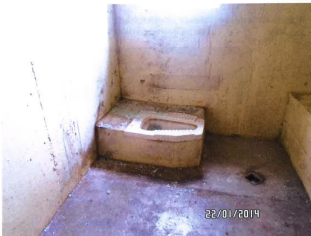
Imagem 2: Interior de uma cela com pedaços de vidro quebrados no vaso sanitário
