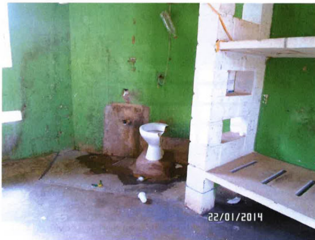
Imagem 5: Cella coletiva com vaso sanitário do banheiro utilizado pelos presos destruído e condições precárias
