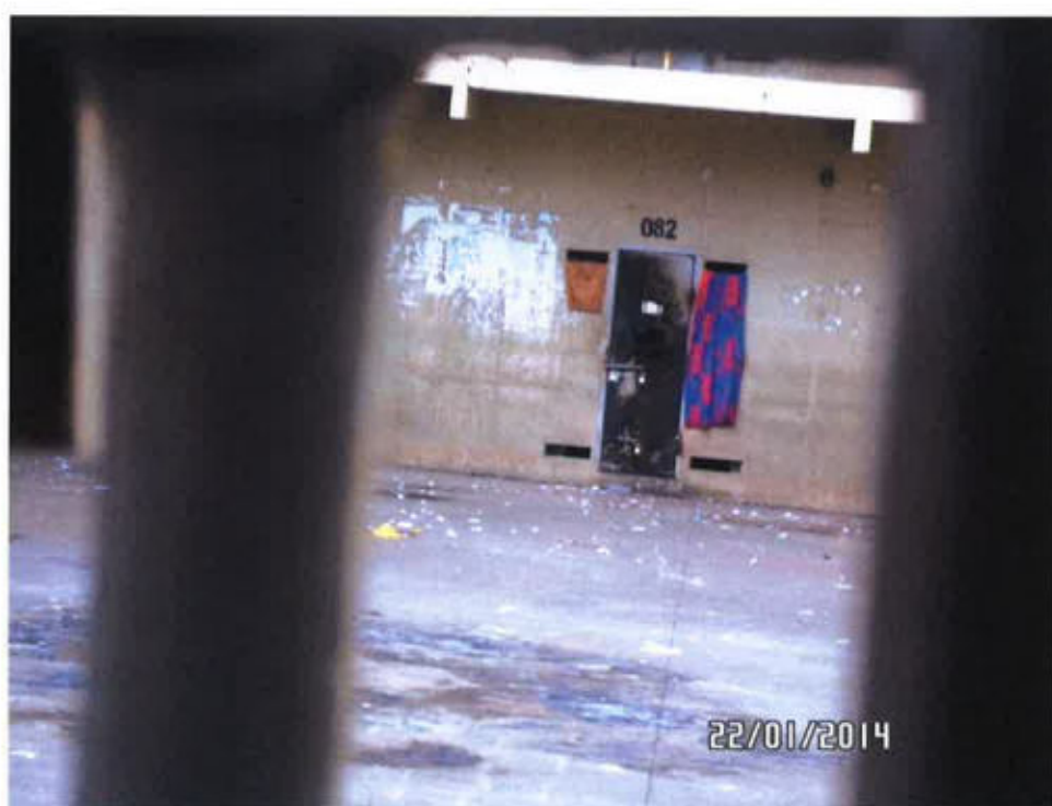
Imagem 38: Porta de uma das celas do raio em que os presos estavam queimada pelo incêndio
