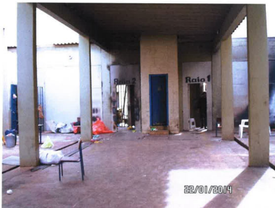
Imagem 30: Entrada dos Raios 1 e 2, com diversas marcas do incêndio
