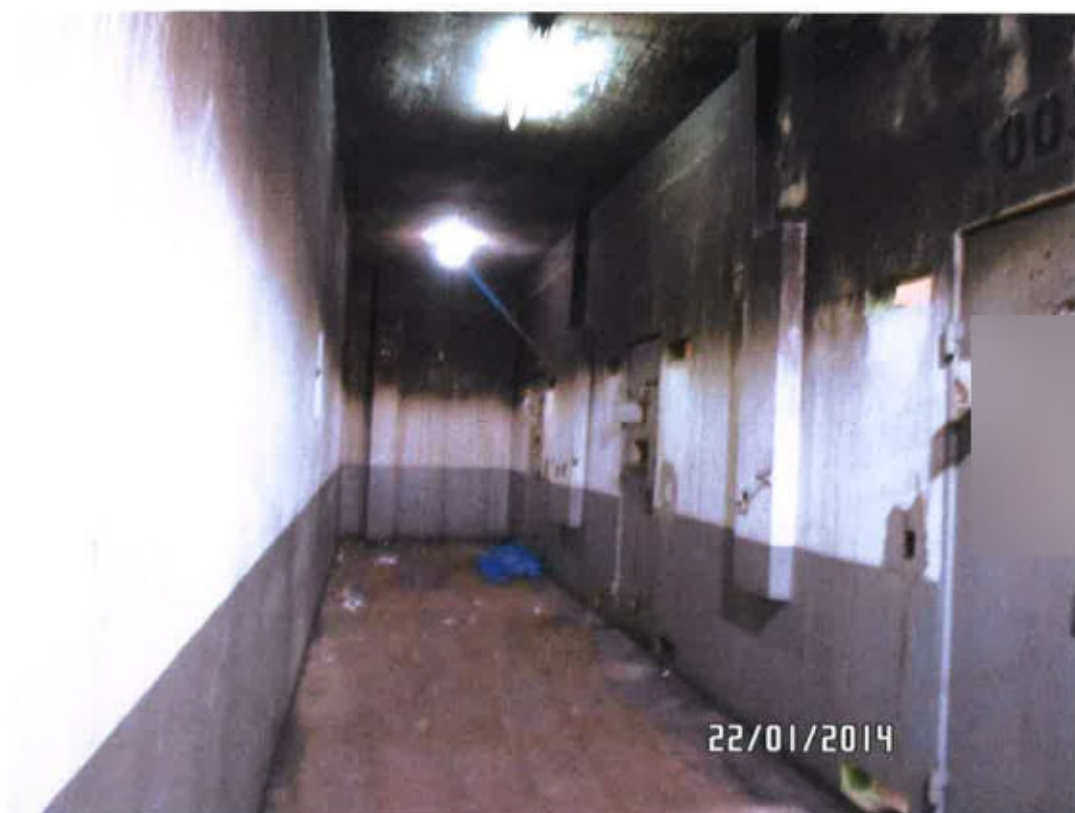
Imagem 41: Celas do seguro com parte da parede totalmente queimada pelo incêndio
