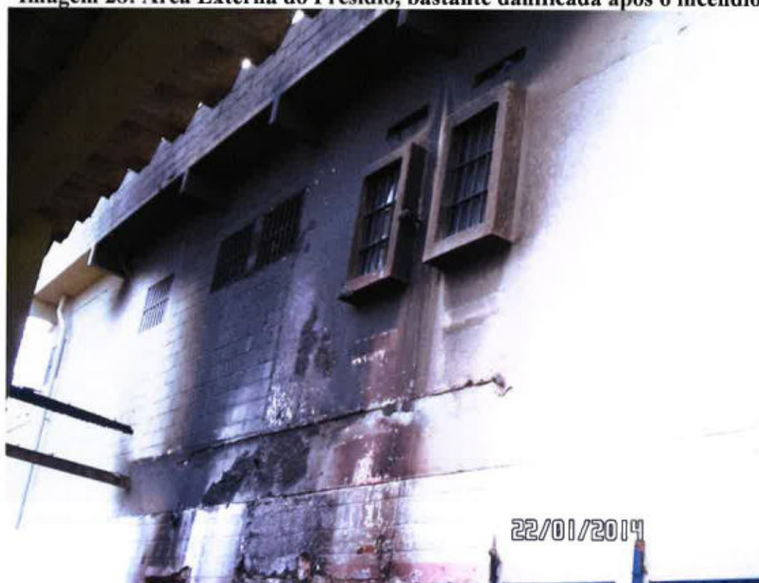
Imagem 28: Área Externa do Presídio, bastante danificada após o incêndio
