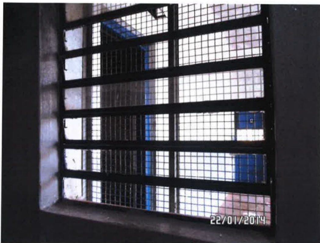
Imagem 29: Janelas do presídio quebradas
