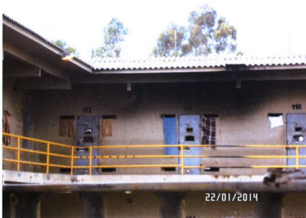
Imagem 39: Paredes do raio em que os presos se encontravam após a rebelião do dia 13/01/2014, queimadas pelo incêndio.
