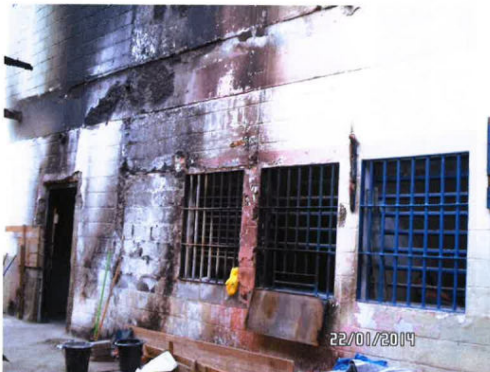
Imagem 28: Área Externa do Presídio, bastante danificada após o incêndio
