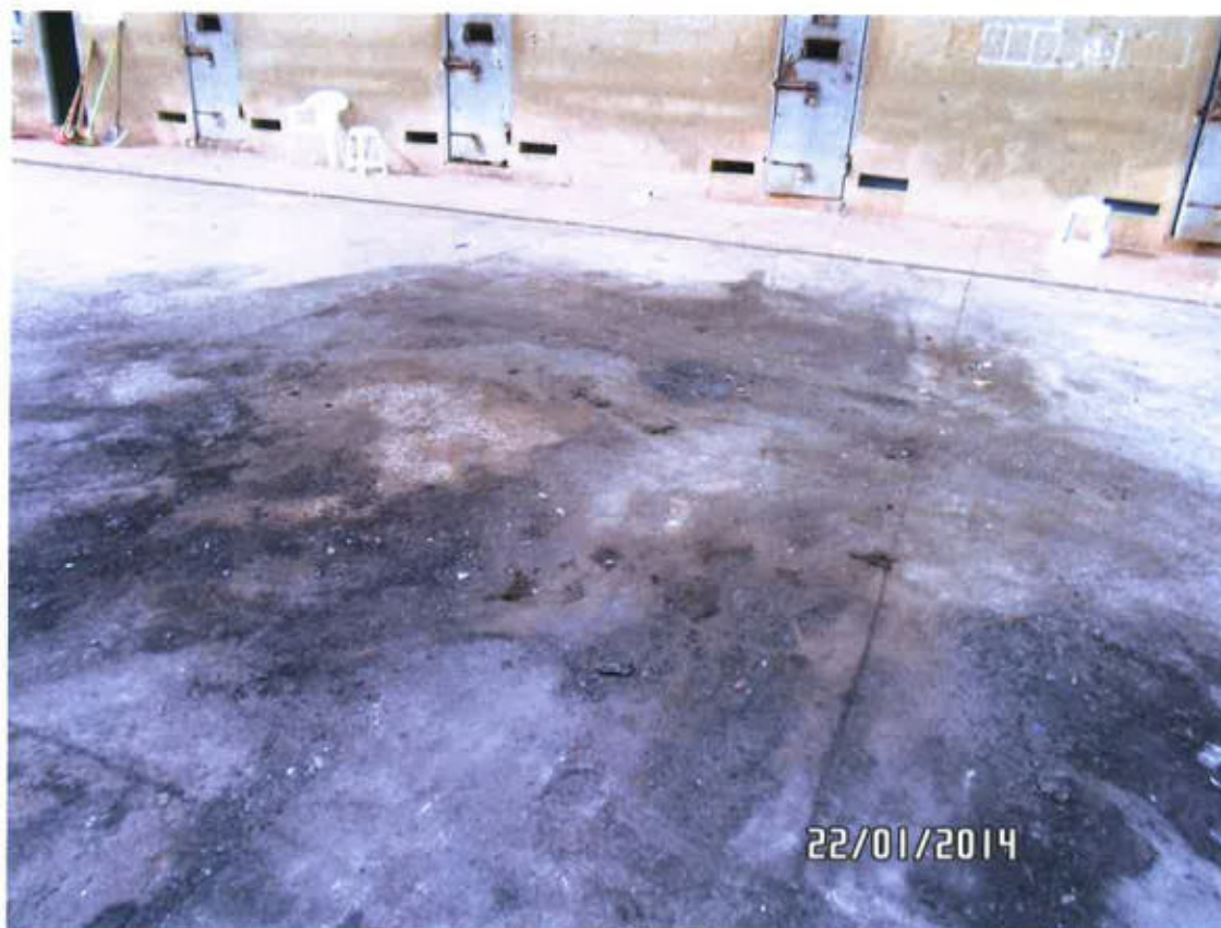
Imagem 34: Fuligem do incêndio no pátio de um dos raios
