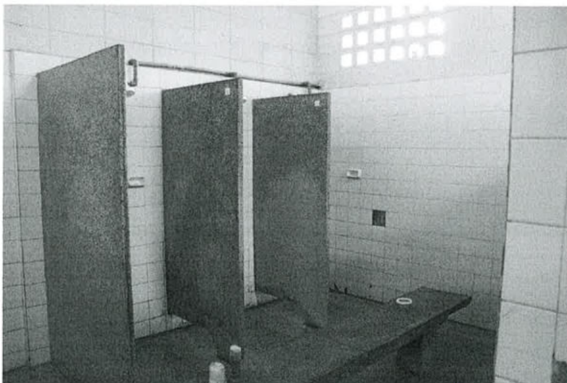
Figura 14. Chuveiros dos banheiros coletivos existentes em cada ala.
