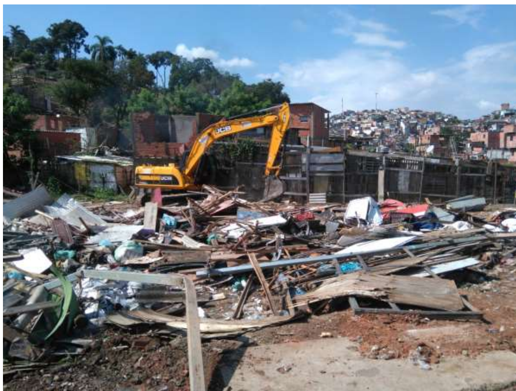
Imagem 4: Escombros da remoção na área do Córrego do Bispo em maio de 2019, no Peri Alto, Zona Norte.
