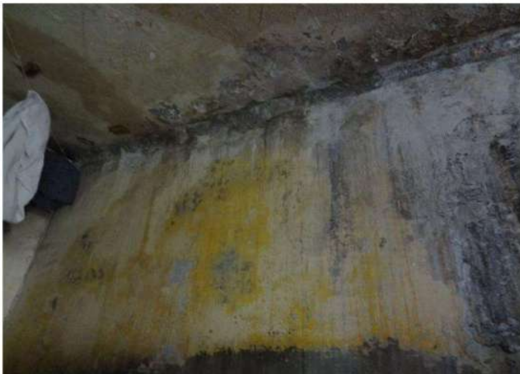
(infiltrações na parede, umidade escorrendo)
