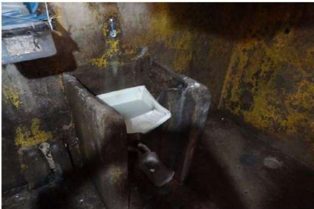
(tanque sem torneira e entupido)
