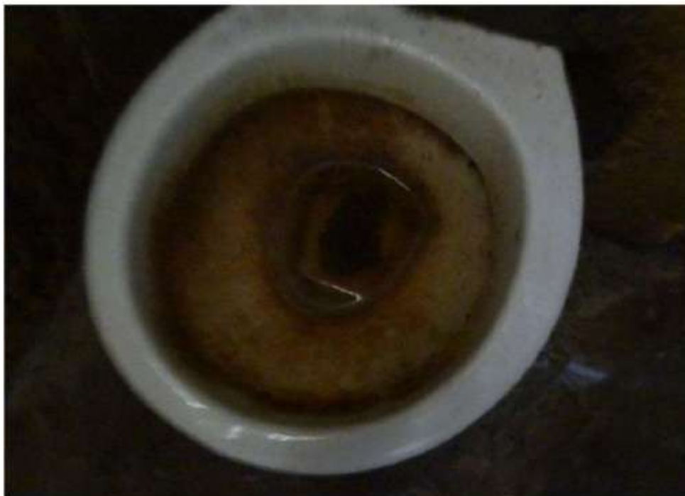
(privada quebrada, sem tampa, assento, entupida e suja)
