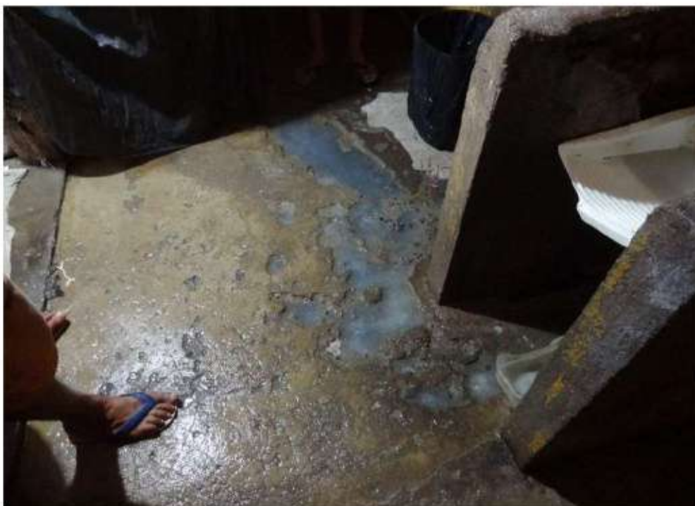
(água vazando, poças no chão)
