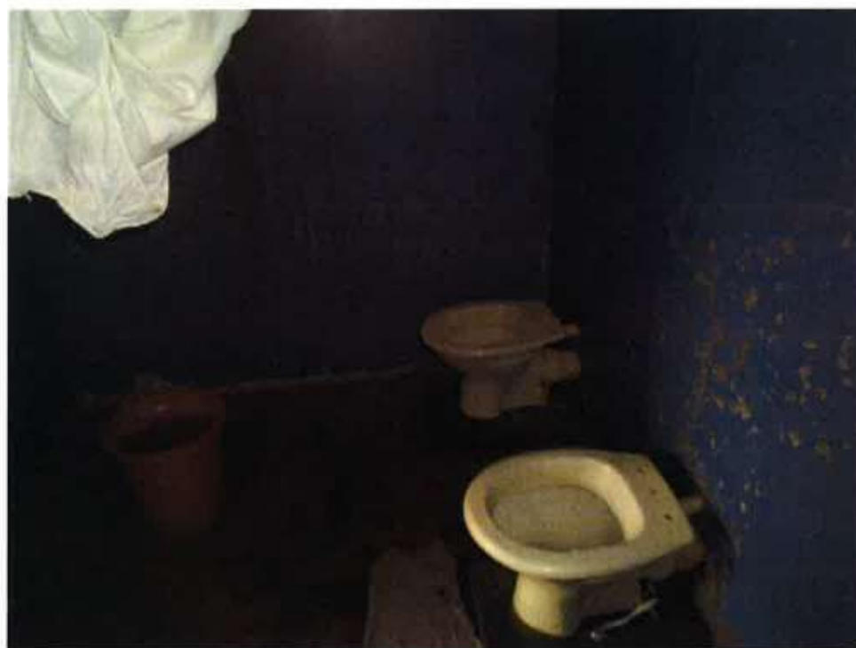
Foto 56 – Cella úmida e em má conservação.
