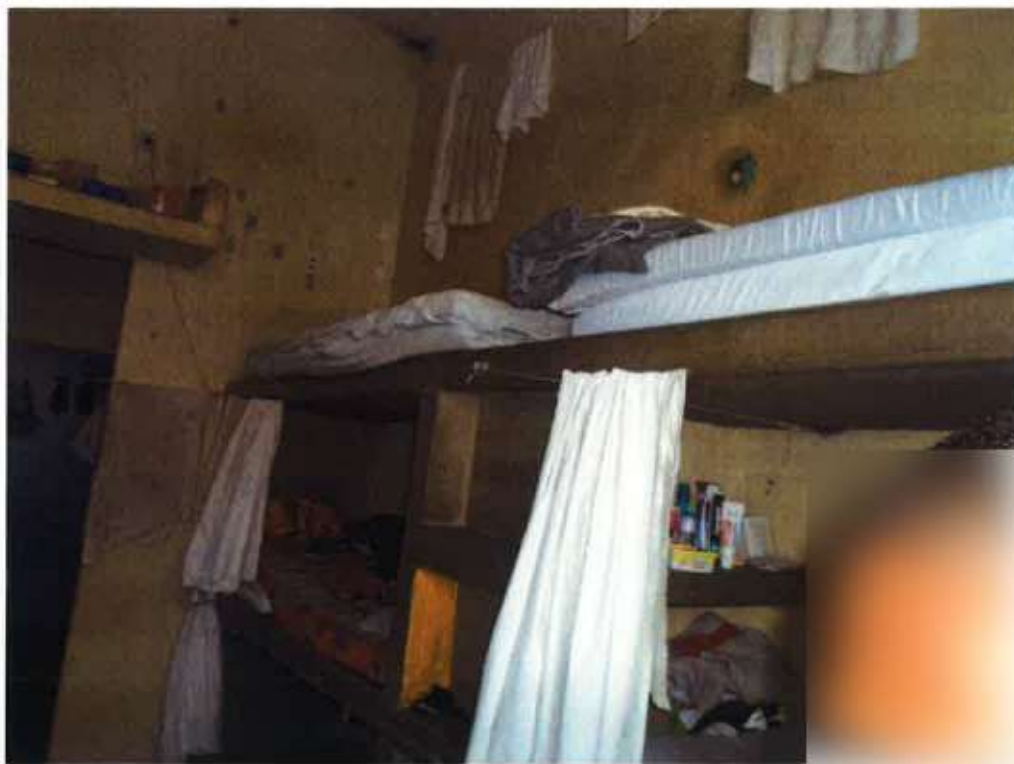
Foto 61 – Cella úmida com as roupas secando em seu ambiente. Perigo de choque com os fios elétricos.
