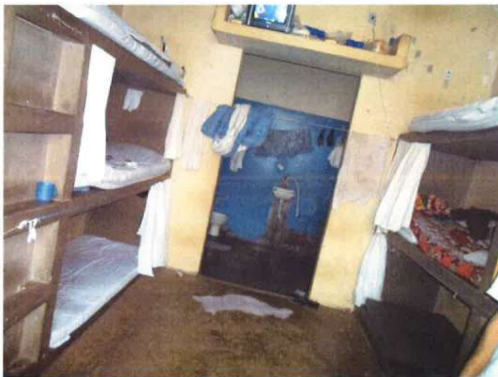
Foto 60 – Cella úmida e em mau estado de conservação.
