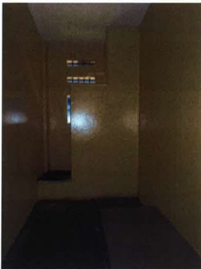
Foto 23 - Celas do setor de inclusão em regular estado de conservação.
