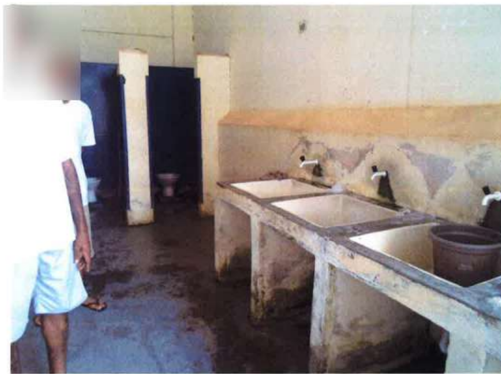
Foto 80 – Lavatório do raio em mau estado de conservação.
