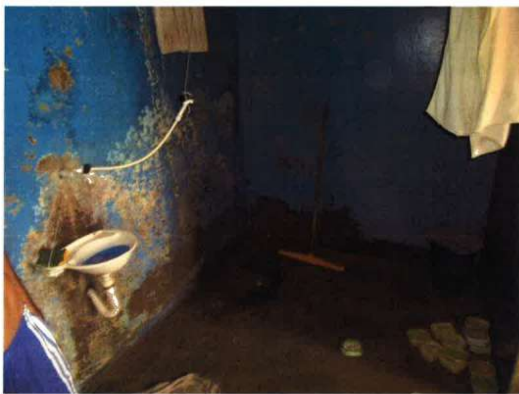
Foto 52 – Celas em péssimo estado de conservação. Há pleno comprometimento da higiene dos sentenciados.
