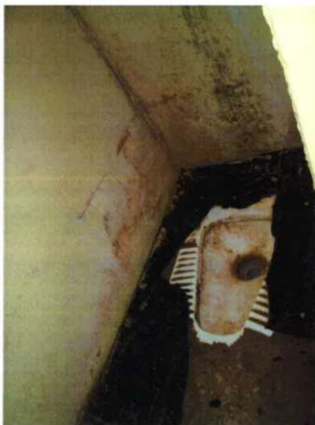
Foto 24 – Cella do setor de inclusão em péssimo estado de conservação.
