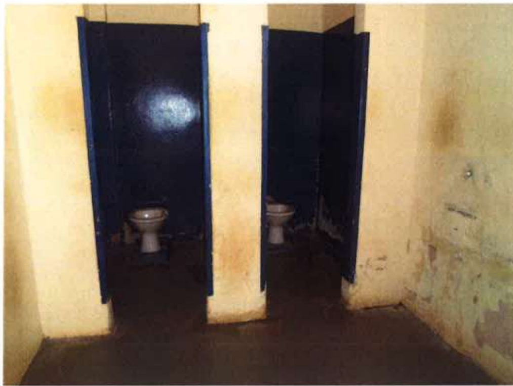
Foto 79 – aparelhos sanitários no lavatório do raio.
