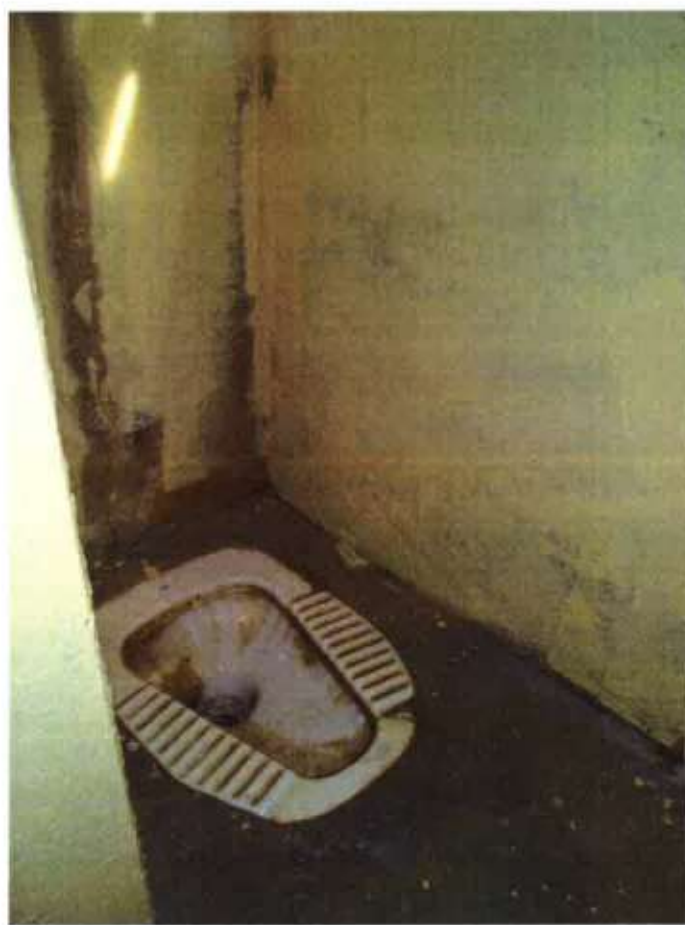
Foto 20 - Aparelho sanitário em mau estado de conservação no setor de inclusão.
