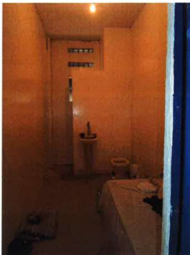
Foto 17 - Cella do setor de enfermaria em mau estado de conservação. Preso com tuberculose.
